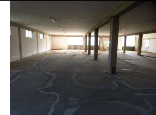
Piano seminterrato, si notano le tracce di risalita capillare d'acqua dal sottofondo
