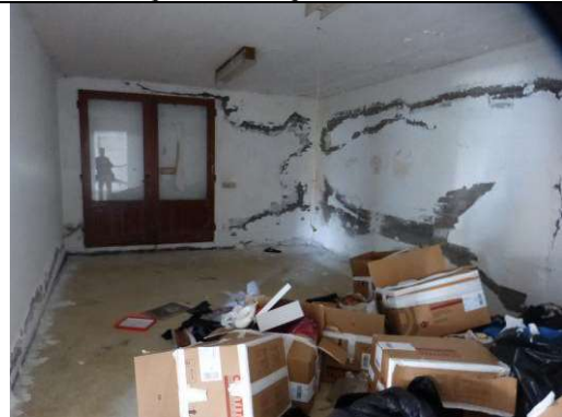
Locale ufficio con tracce di umidità
