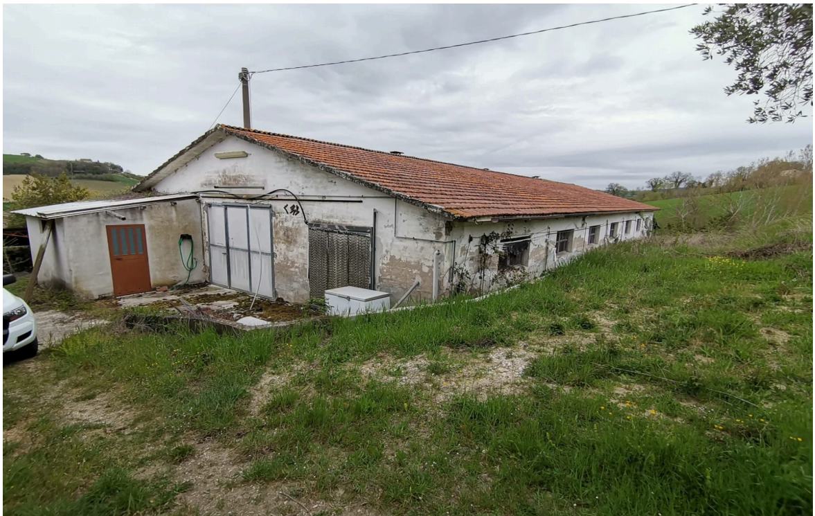
FOTO LATO NORD/OVEST FABBRICATO PRINCIPALE E PARTICOLARE LOCALE ABUSIVO DA DEMOLIRE
