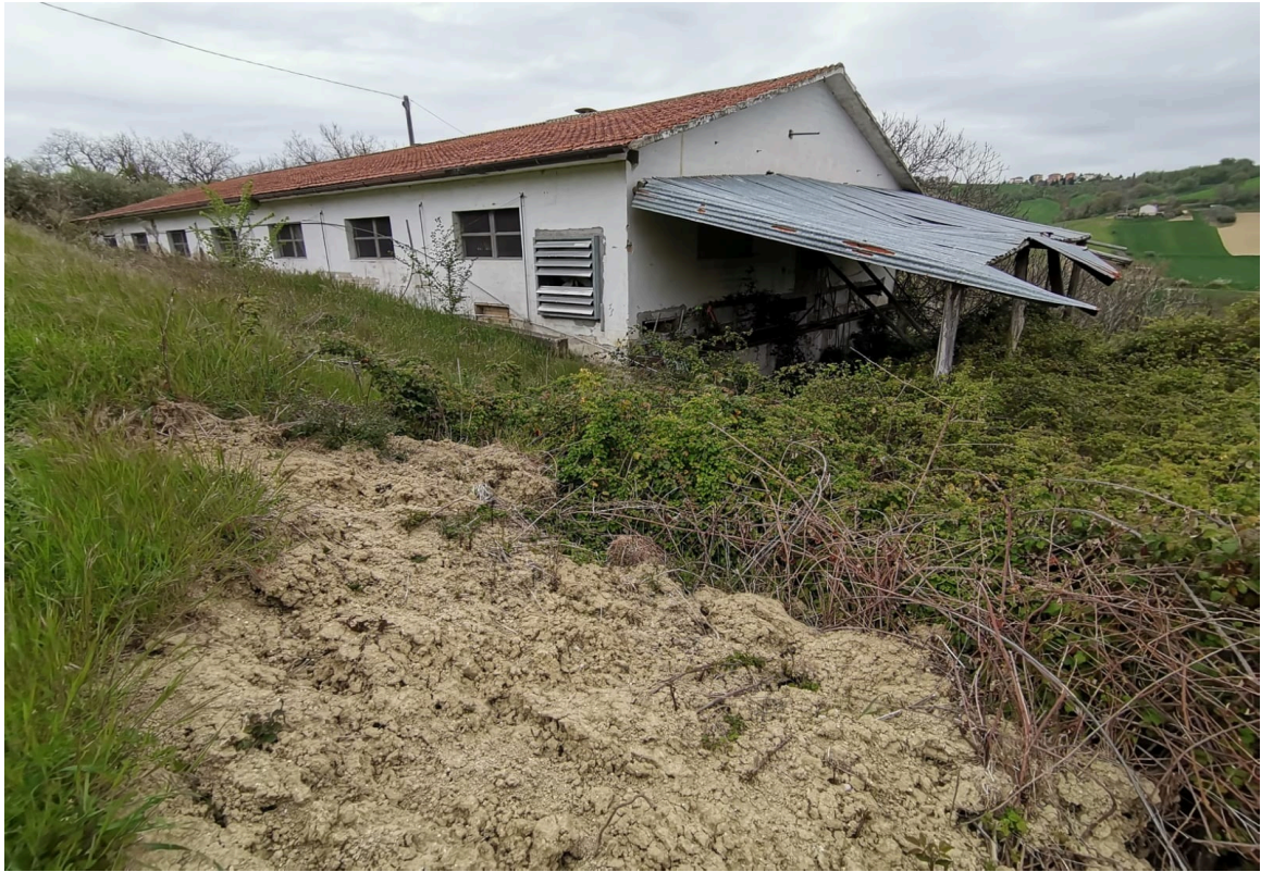
FOTO LATO SUD/OVEST FABBRICATO PRINCIPALE E PARTICOLARE TETTOIA ABUSIVA DA DEMOLIRE
