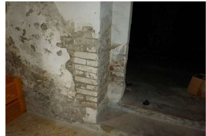
particolare muratura e degrado
