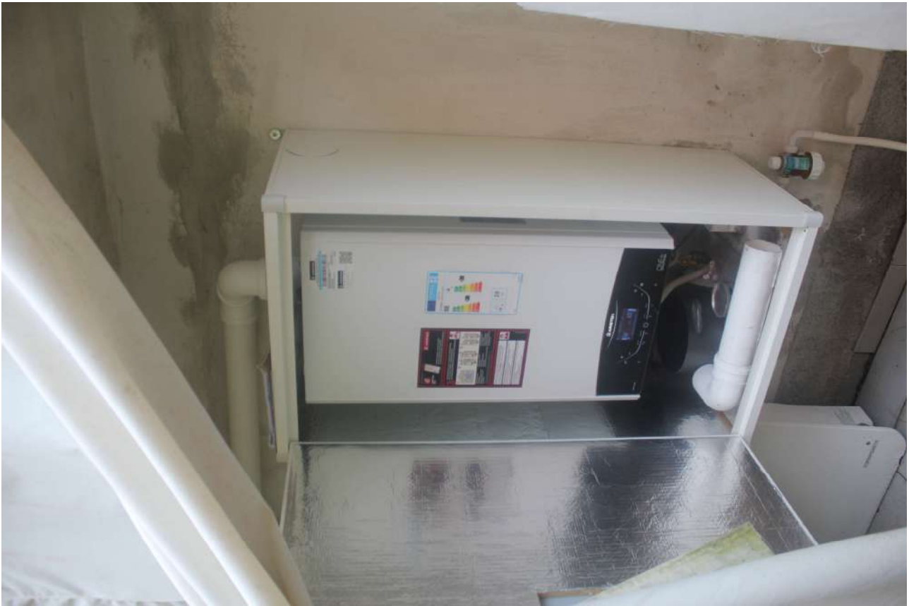
Foto 15 – Particolare caldaia a servizio dell'unità
