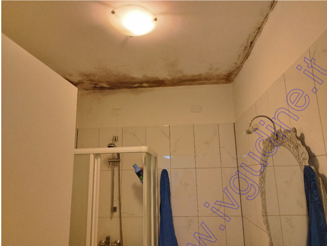
Particolare muffa soffitto bagno
