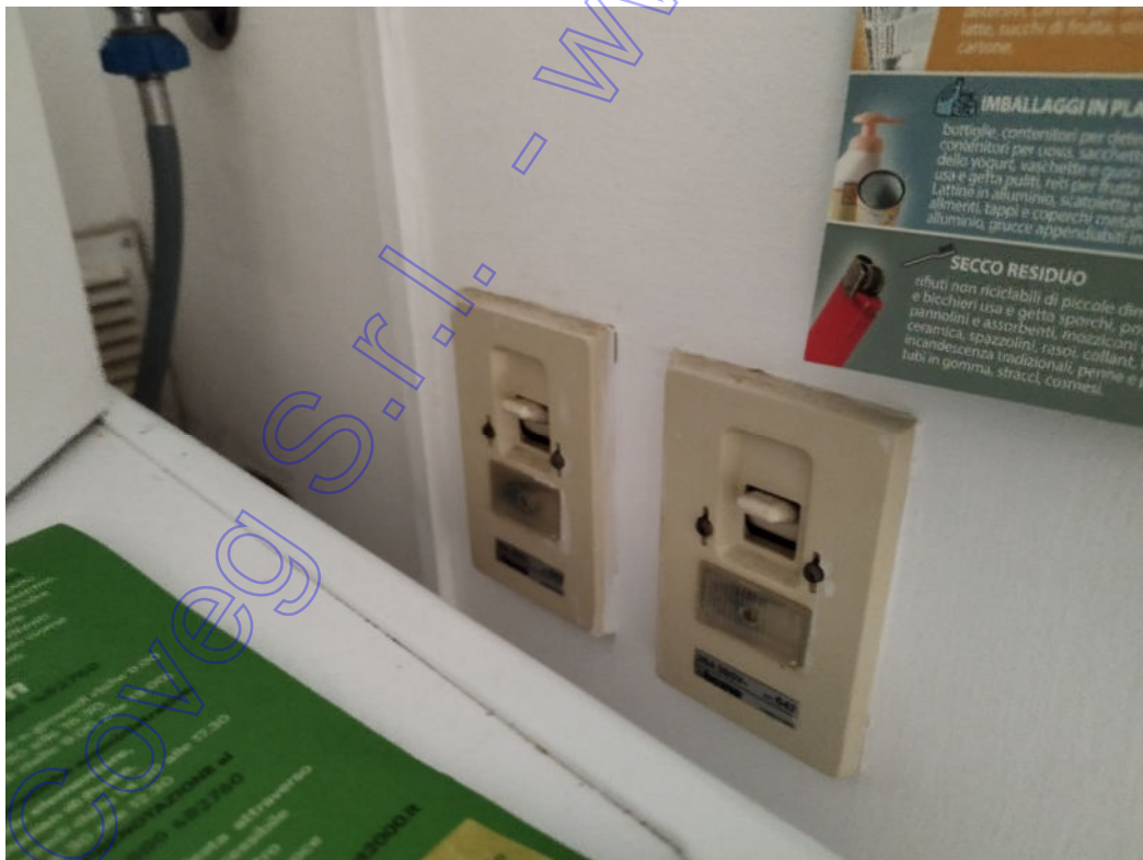
Particolare impianto elettrico caldaia
