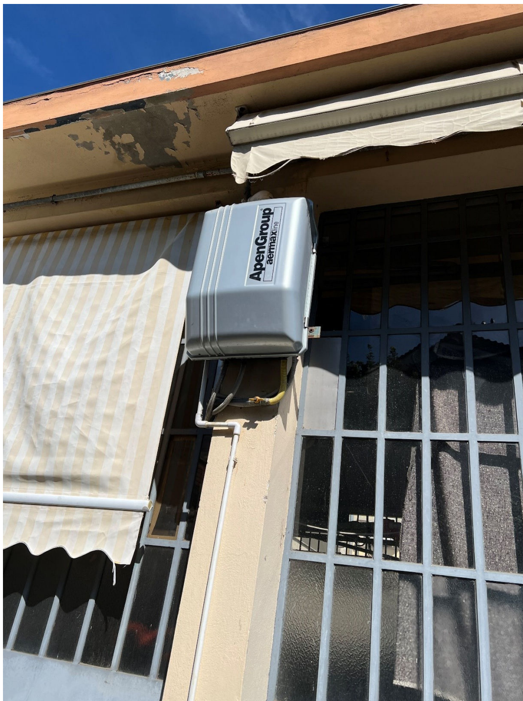
Foto 12_Foto generatore ad aria calda laboratorio
