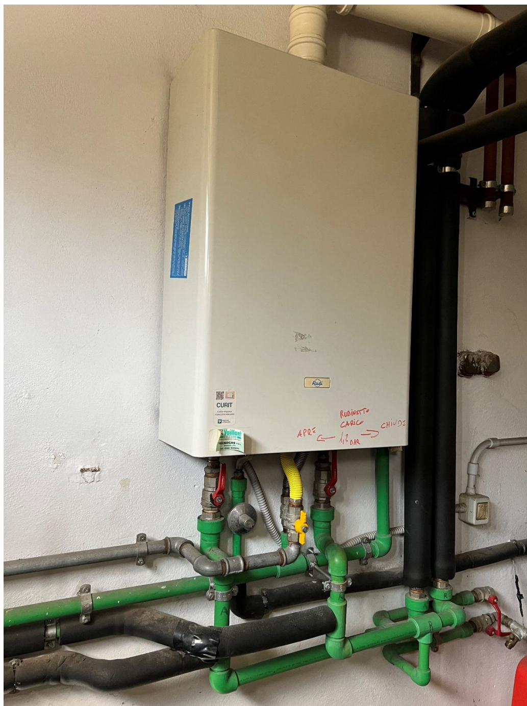
Foto 16_Generatore impianto riscaldamento e produzione acqua calda sanitaria zona uffici
