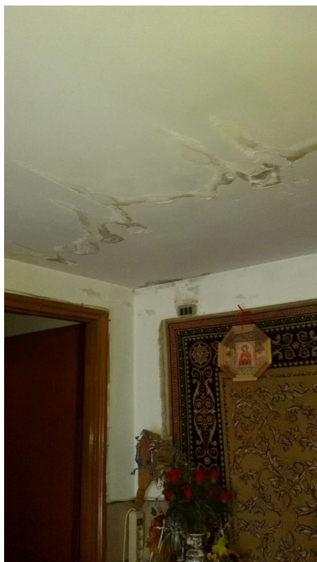
Foto nr. 10: particolare umidità
