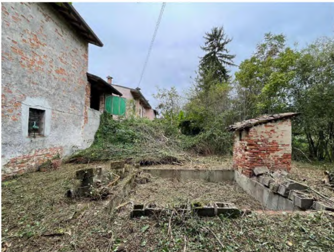
Prospetto nord immobili e particolare latrina oggetto di perizia (vista da giardino)
