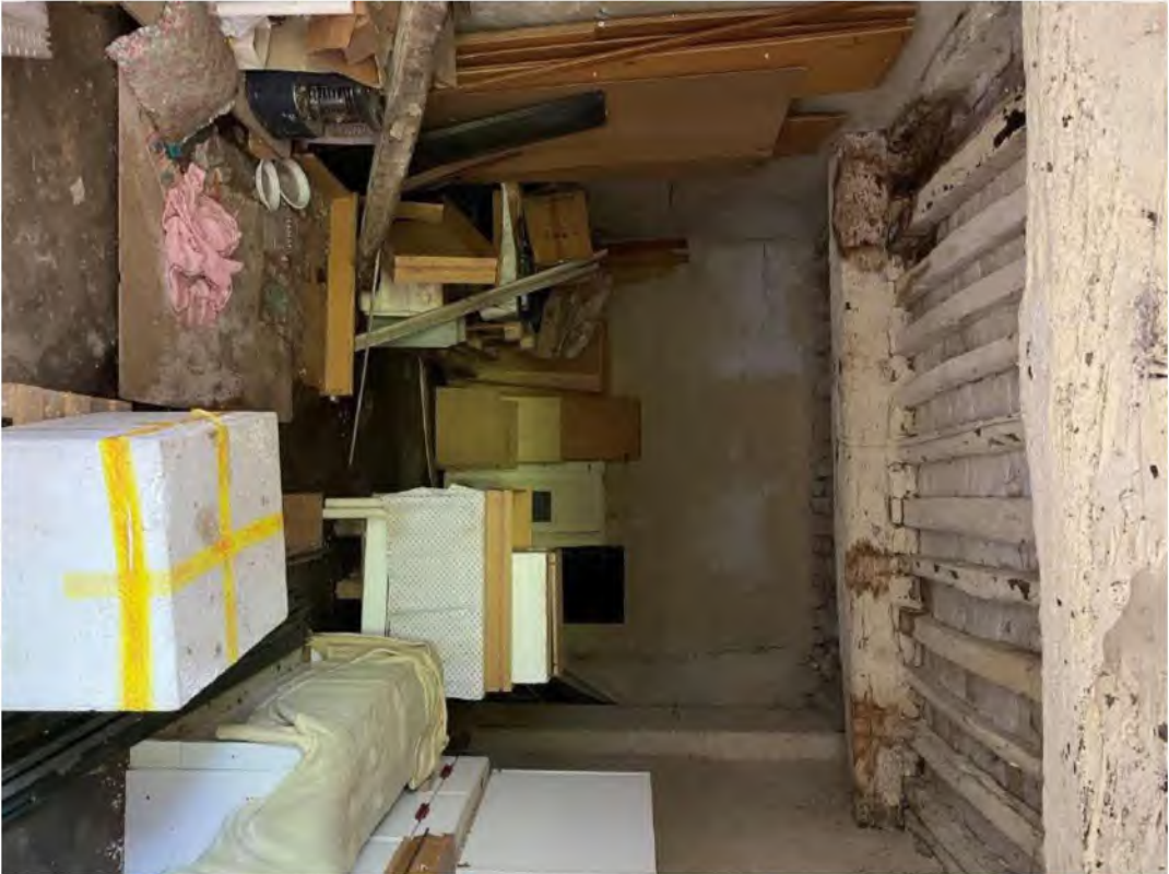
Vista interna abitazione – sgombero piano terra
