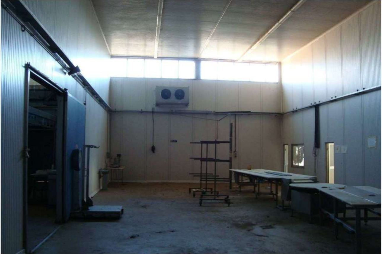
■ Figura 28 vista interna della cella del fabbricato opificio della particella 52 foglio 32 comune di Lamezia Terme
