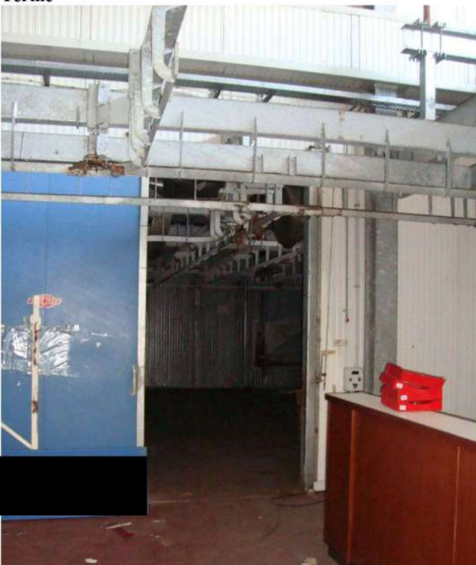
■ Figura 27 vista interna della cella del fabbricato opificio della particella 52 foglio 32 comune di Lamezia Terme
