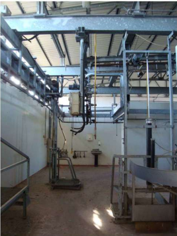
■ Figura 21 vista interna del fabbricato macello della particella 167 foglio 32 comune di Lamezia Terme
