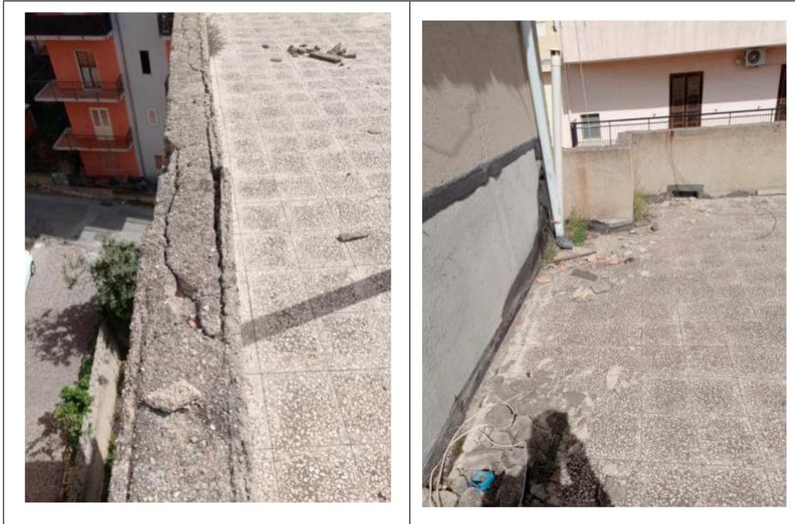
Foto 62 e 63. Particolari dei danni rilevati in terrazza, dove si osservano parapetti crepati ed assenza di impermeabilizzazione, nonché depositi di materiale inerte, ovunque
