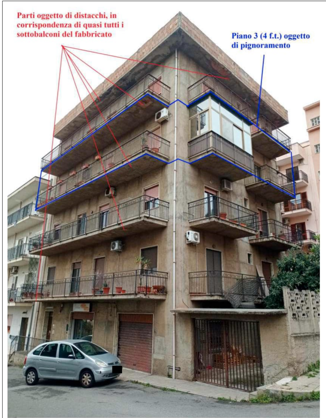
Foto 56. Prospetto principale e laterale (quest'ultimo non oggetto di spicconamento da parte dei Vigili del Fuoco) dove si denotano le parti immediatamente pericolanti del fabbricato
