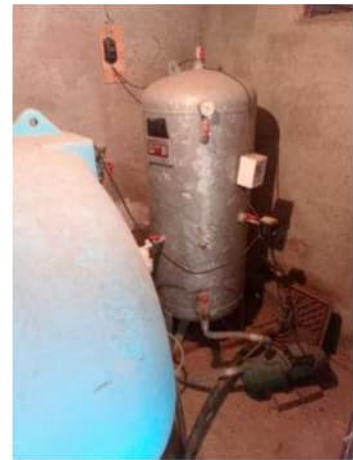
Foto 15 e 16. Particolari del motore dell'impianto autoclave
