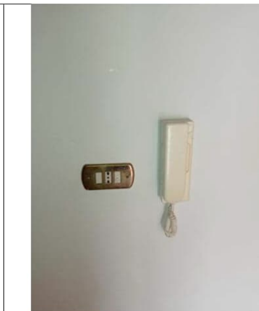
Foto 23. Particolare del sistema citofonico posto all'interno dell'immobile, di che trattasi
