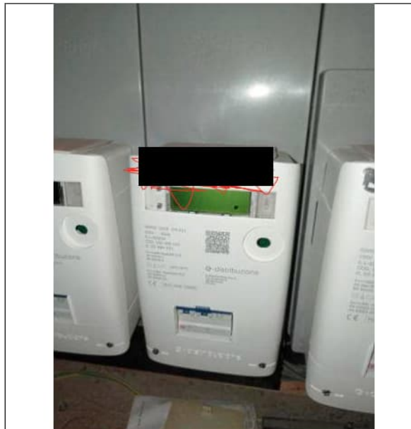
Foto 8. Particolare del contatore elettrico che serve l'appartamento posto al piano terzo
