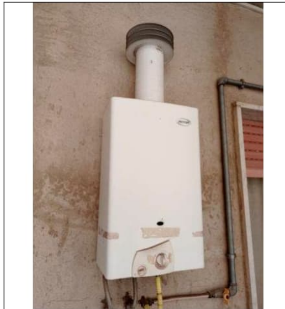
Foto 21. Vista del presente scaldino per l'acqua calda sanitaria
