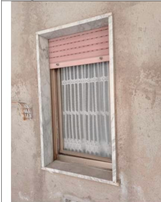
Foto 42. Particolare della tipologia di finestra, in alluminio, ad un'anta, vetro singolo, con avvolgibile in PVC
