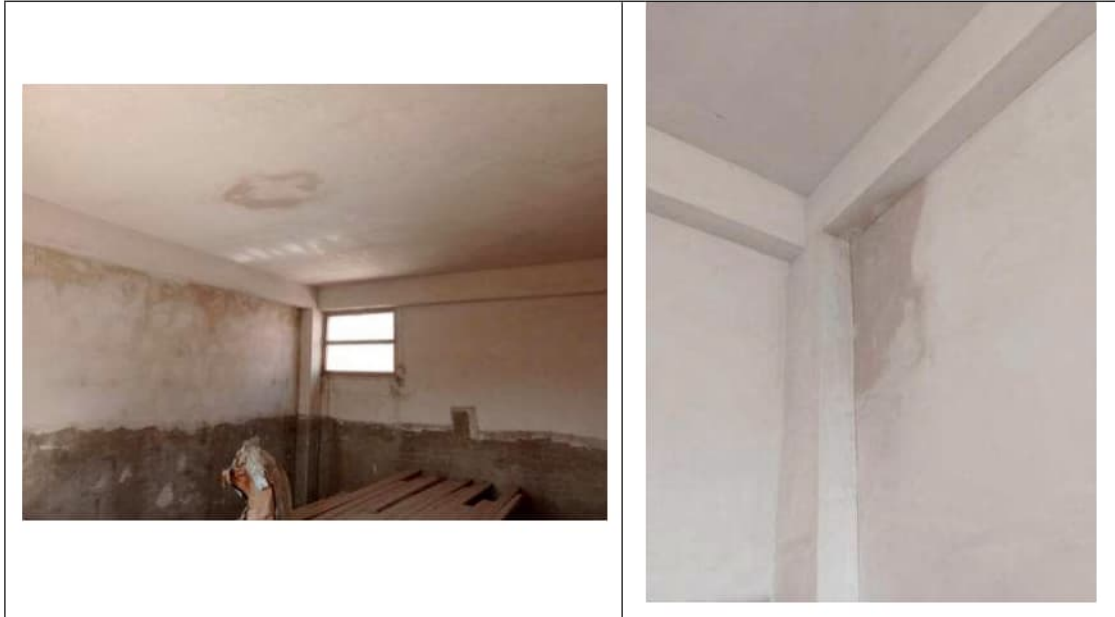
Foto 58 e 59. Particolari dei danni riscontrati sulle superfici dell'abbaino, in corrispondenza del tetto e delle pareti
