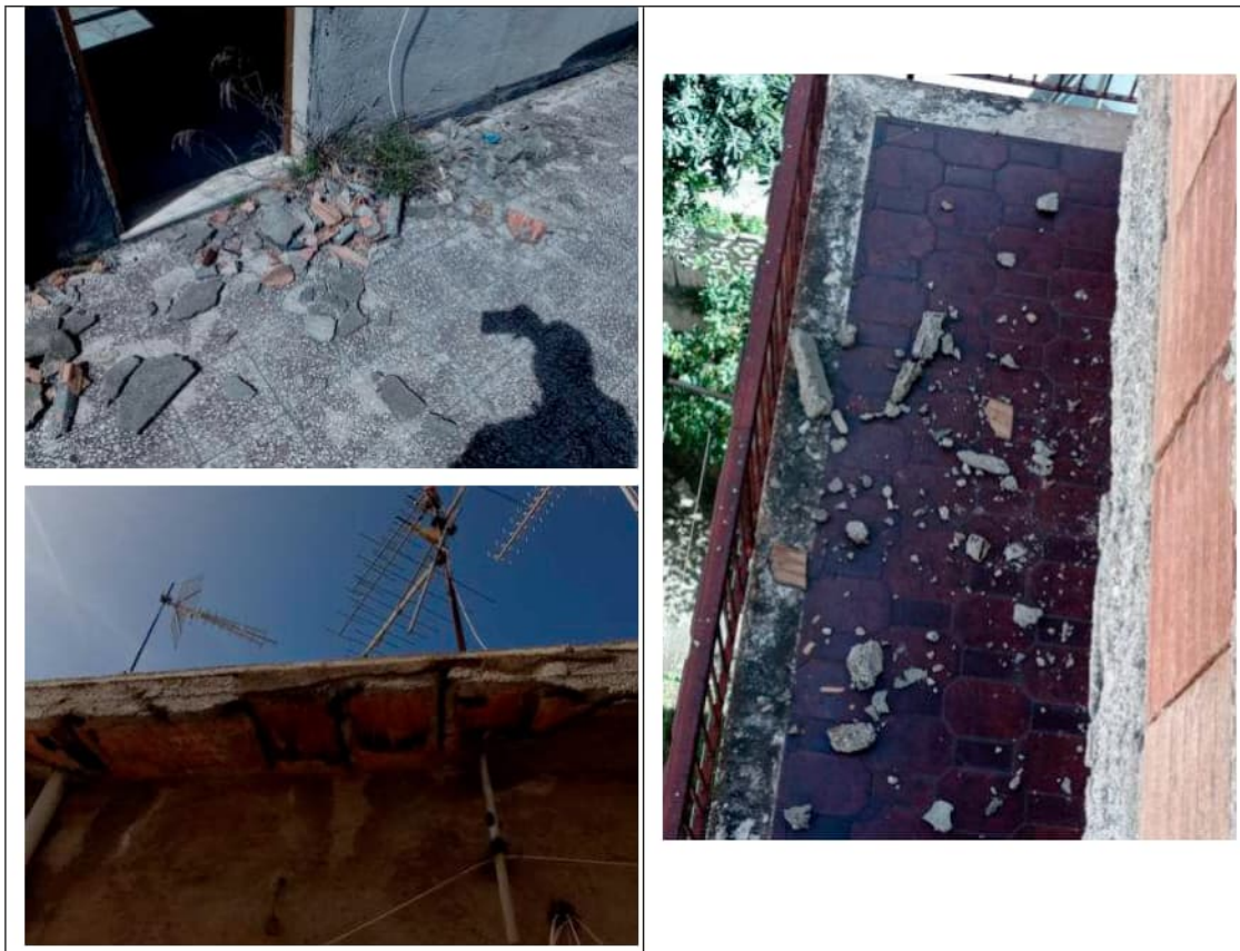
Foto 64, 65 e 66. Particolari dei danni rilevati sull'abbaino, dove si osservano gli evidenti distacchi dell'intonaco a causa dell'espulsione del copriferro
