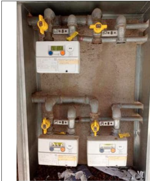
Foto 17. Particolare dei contatori gas metano, posti all'esterno del fabbricato, che servono i vari appartamenti
