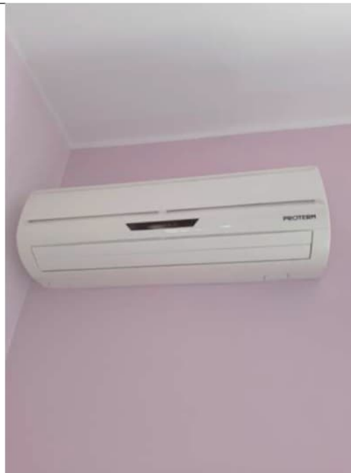
Foto 20. Particolare dello split interno del sistema di condizionamento
