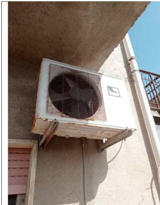
Foto 19. Particolare del motore condizionatore posto all'esterno del fabbricato
