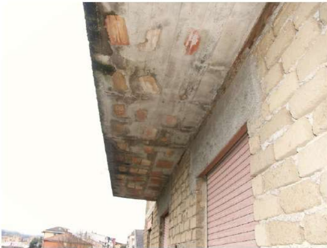
Sotto balcone piano superiore
