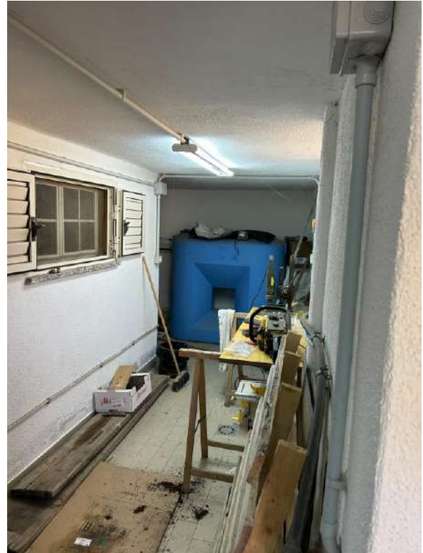
Foto 130 Vista interna locale tecnico
