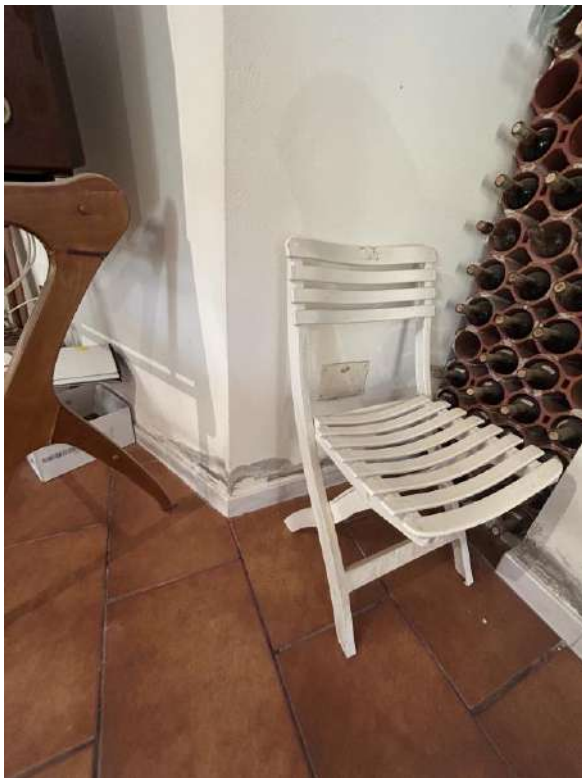
Foto 47 Particolare umidità muri seminterrato
