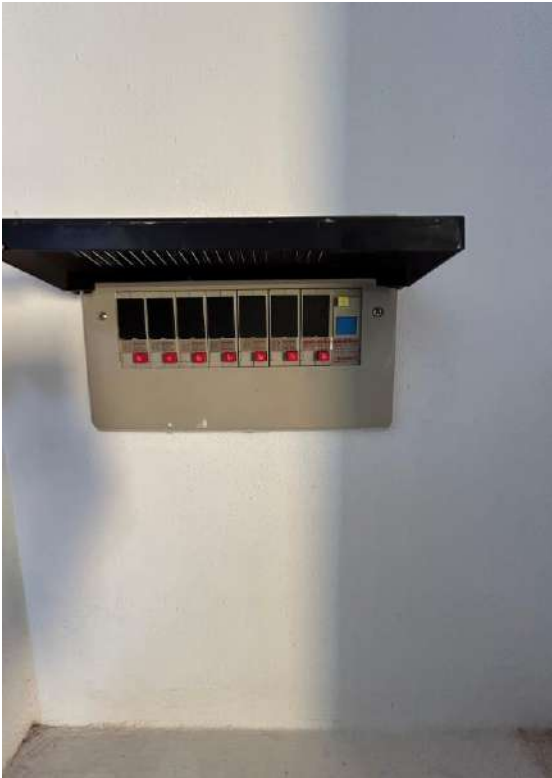
Foto 133 Particolare quadro impianto elettrico
