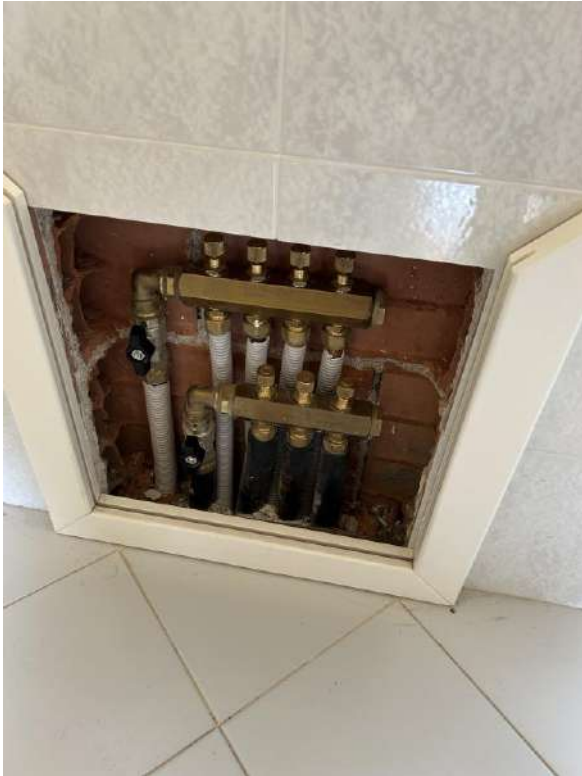
Foto137 Particolare centraline impianto termico termico e idrico
