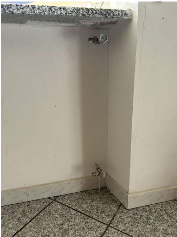
Foto 139 Particolare tubazioni impianto termico
