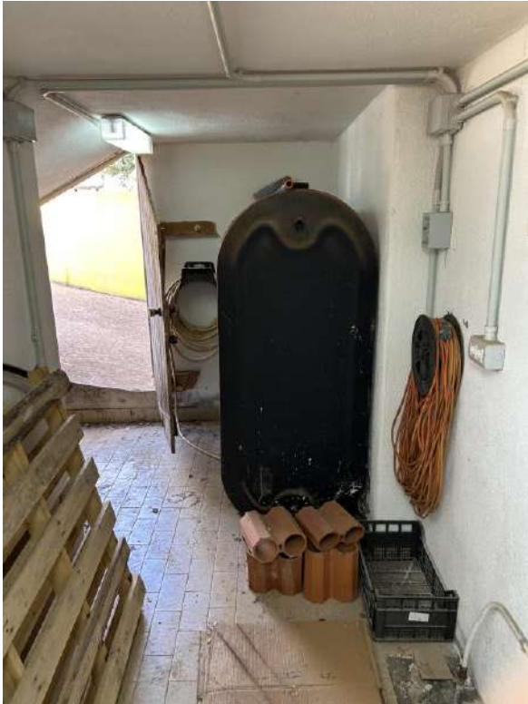
Foto 141 Particolare cisterna gasolio impianto termico
