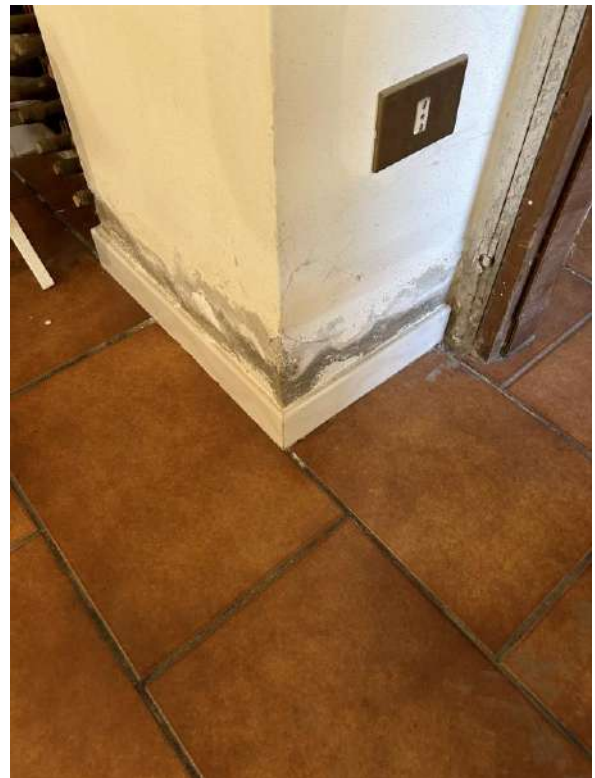
Foto 48 Particolare umidità muri seminterrato
