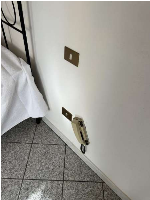
Foto 135 Particolare impianto elettrico e citofonico
