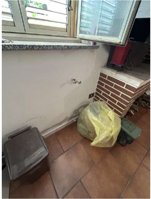
Foto 34 Particolare umidità muri locale di sgombero
