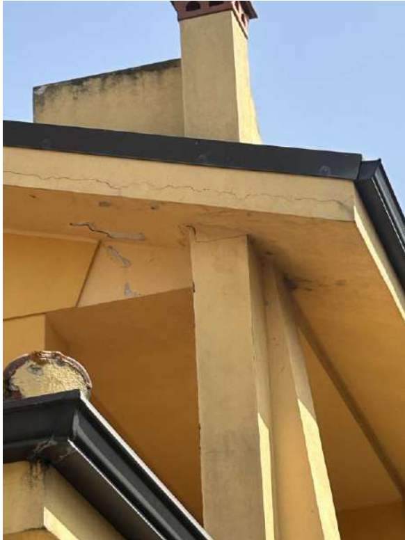
Foto 17 Particolare fessurazioni e muffa facciata
