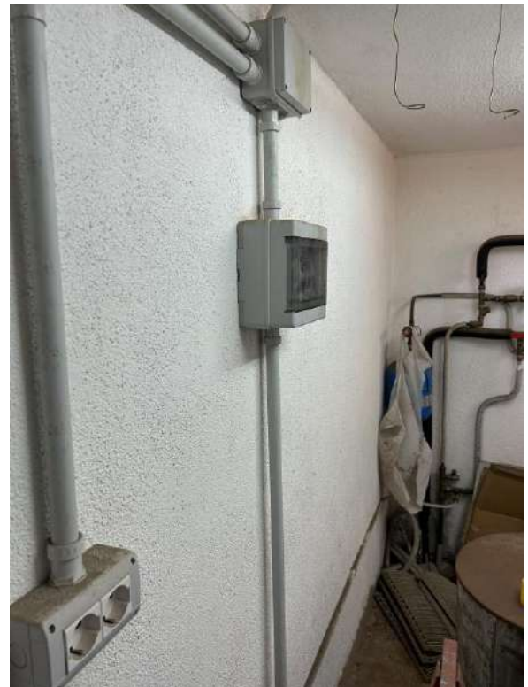
Foto 136 Particolare impianto elettrico locale tecnico
