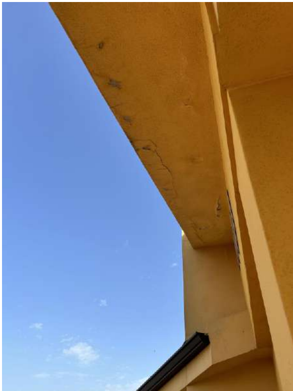
Foto 15 Particolare fessurazioni e muffa facciata
