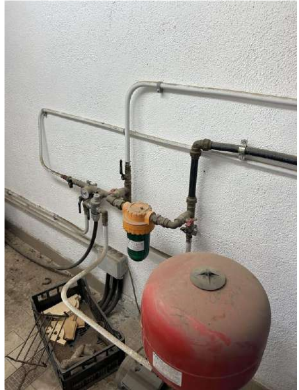
Foto 142 Particolare autoclave per acqua sanitaria
