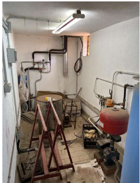
Foto 132 Vista interna locale tecnico
