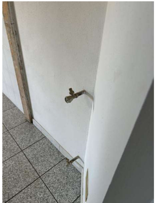
Foto 140 Particolare tubazioni impianto termico
