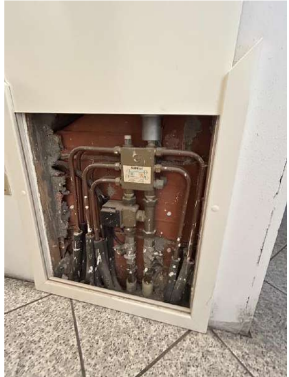
Foto 138 Particolare centraline impianto termico e idrico
