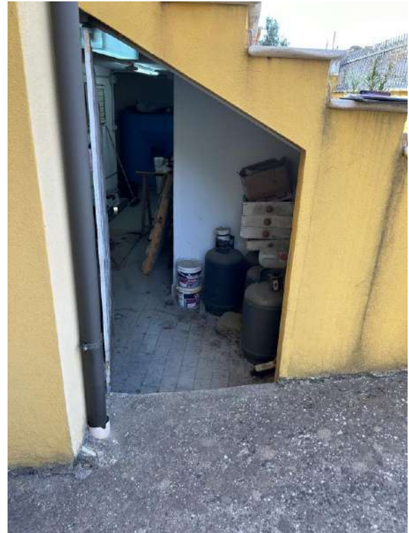
Foto 128 Vista ingresso locale tecnico
