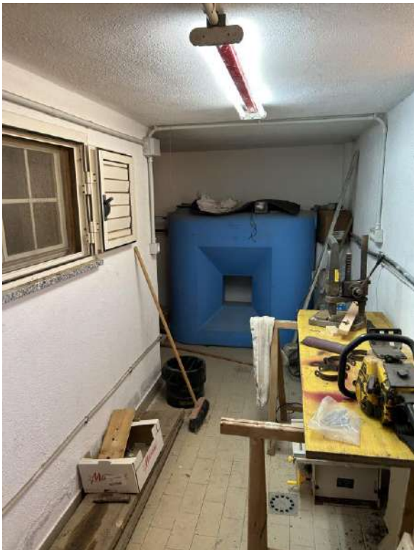
Foto 143 Particolare cisterna impianto idrico
