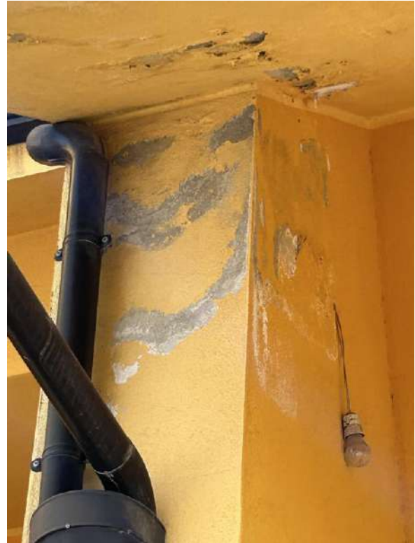
Foto 18 Particolare fessurazioni e muffa facciata
