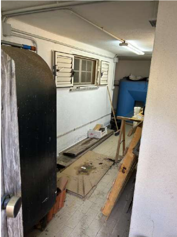
Foto 129 Vista interna locale tecnico
