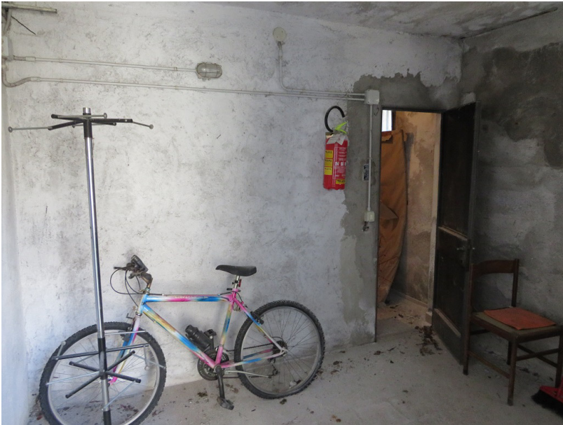
Piano seminterrato Vista zona centrale termica
