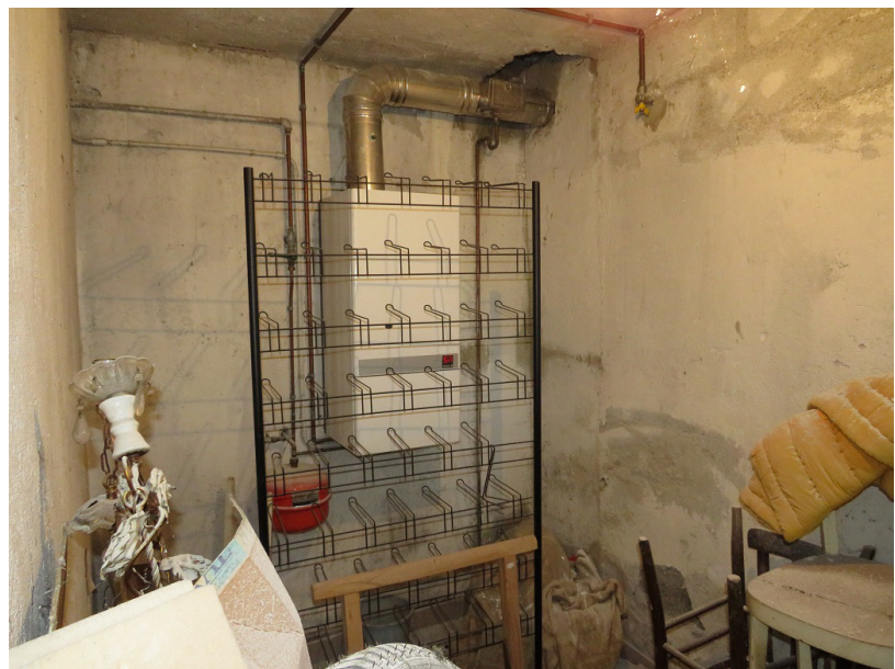
Piano seminterrato Vista locale caldaia
