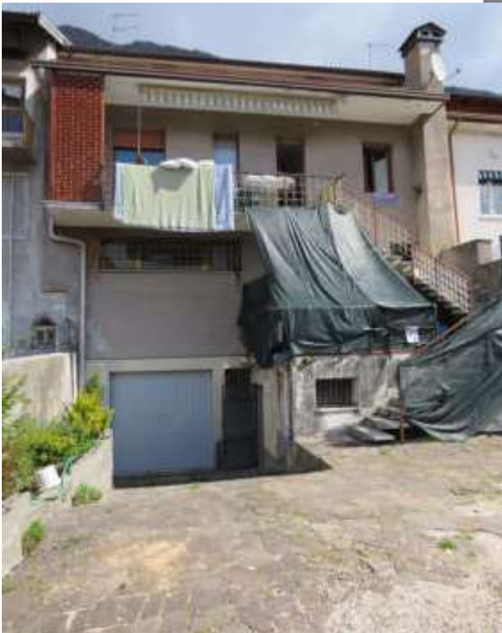
Vista del fronte verso la corte interna
