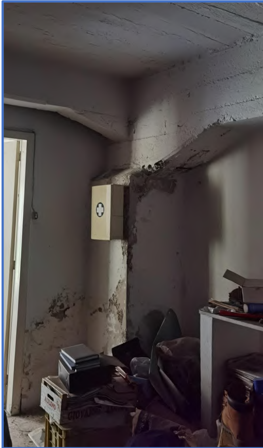
Foto 48 – Vista del particolare del sistema costruttivo del fabbricato: travi rinforzate sostenute da pilastri in muratura di mattoni, di notevole dimensione.
