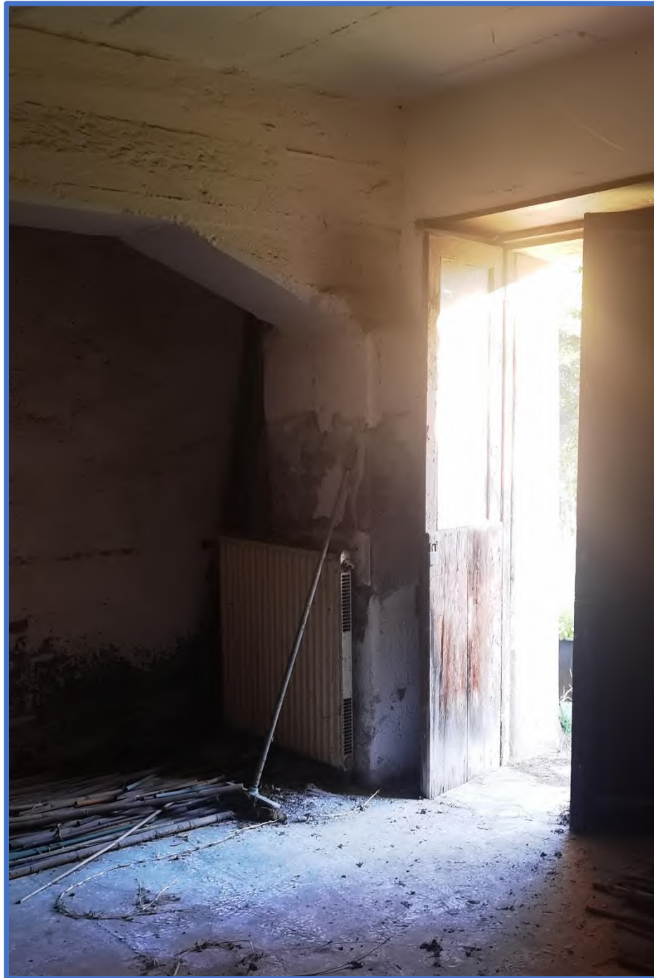
Foto 62 – Camera esposta a sud. Porte uscita corte esterna. Si noti il radiatore dell’impianto di riscaldamento.
