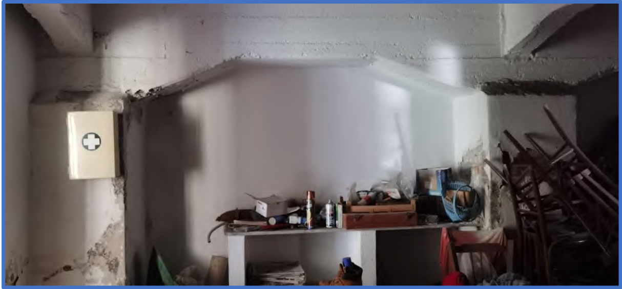
Foto 46 – Vista del locale utilizzato come deposito. Si osserva il sistema costruttivo del fabbricato.
