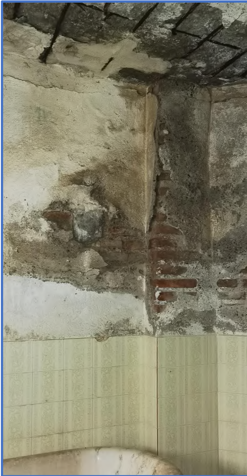
Foto 58 – Bagno. Degrado delle strutture.
