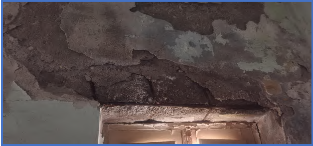
Foto 37– Vista degrado cordolo finestra vano scale.
