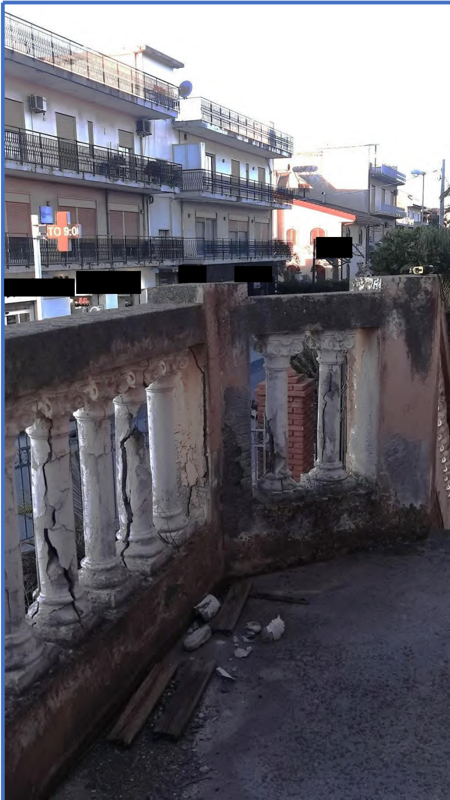
Foto 10 – Scala esterna. Particolare del degrado parapetto.
