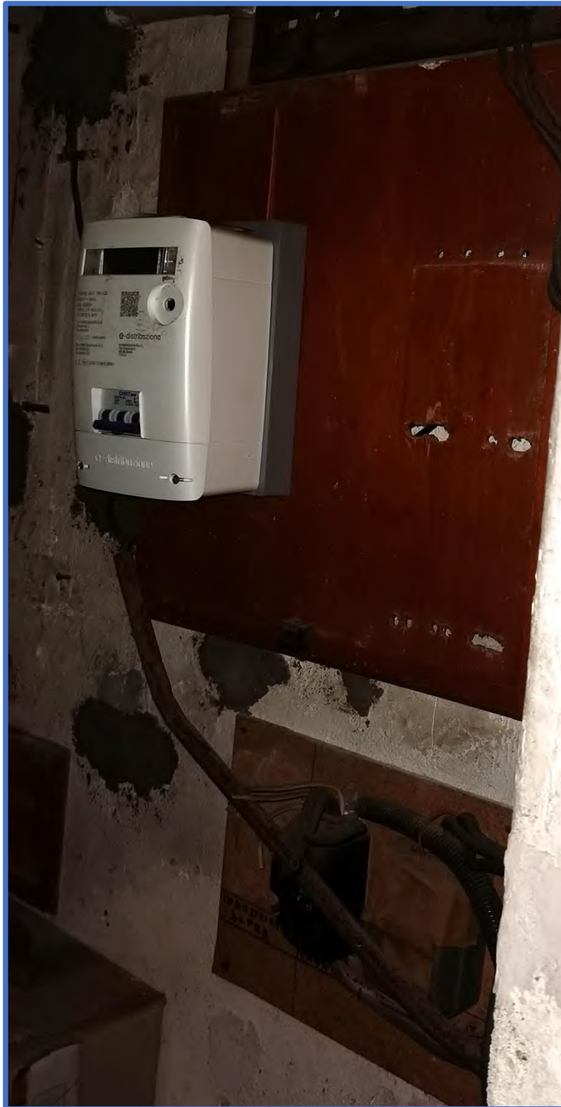
Foto 51–Nuovo contatore collocato nel locale deposito attrezzi.
