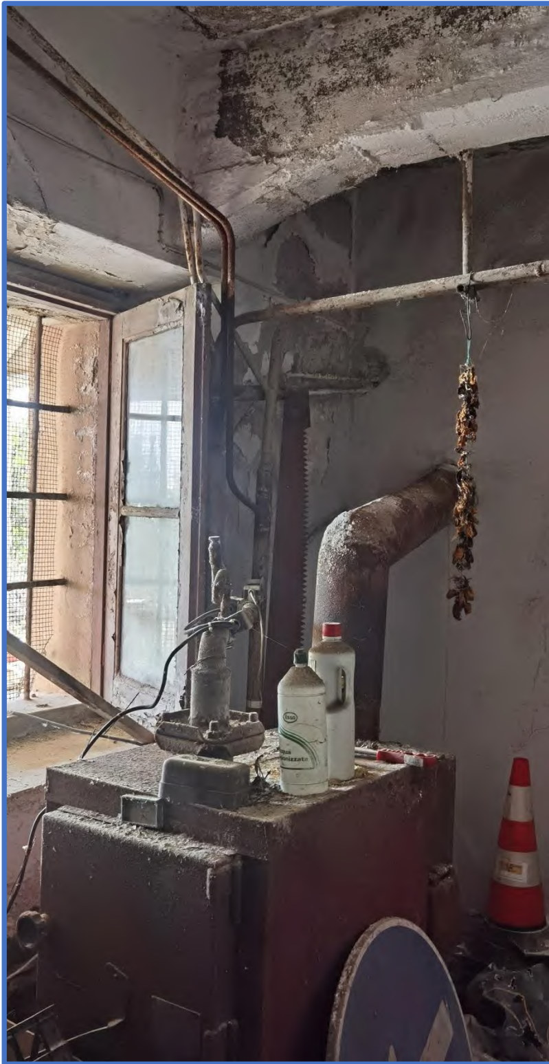
Foto 50– Vista della macchina utilizzata per il riscaldamento dei locali del piano primo e del piano terra.
