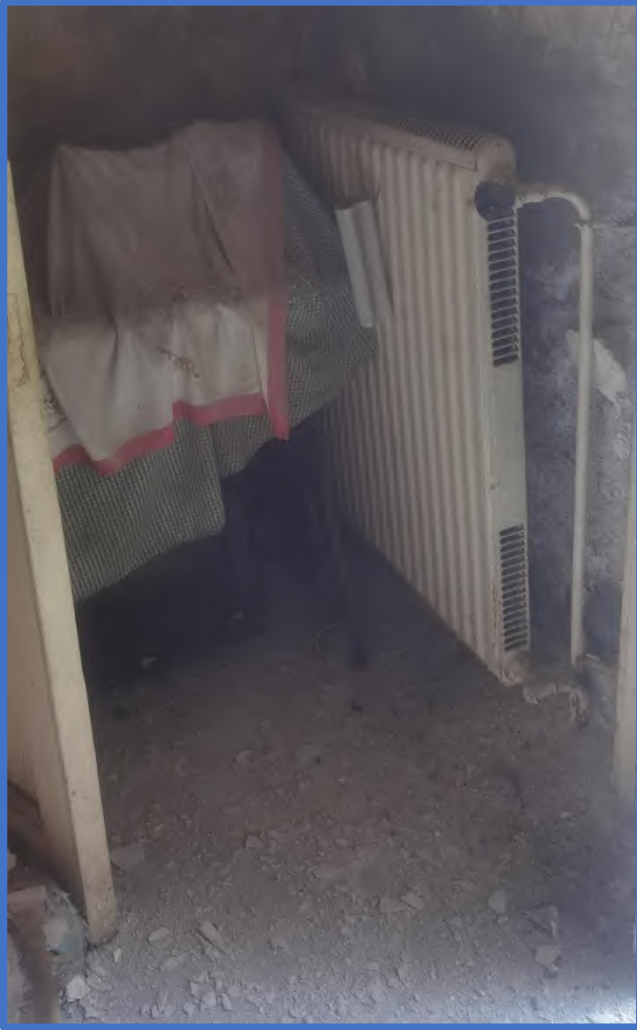
Foto 28– Particolare del pannello radiante collocato dietro la porta che dà sul vano scale.
