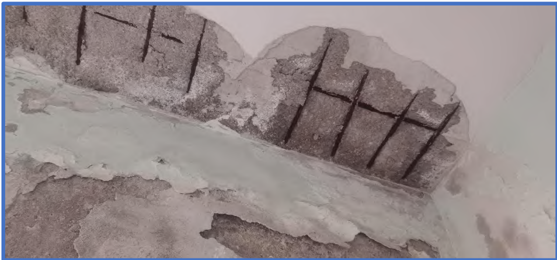
Foto 38 – Vista degrado solaio vano scale.
