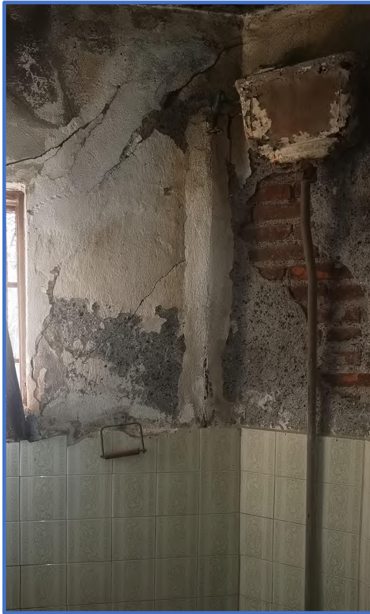
Foto 59 – Bagno. Degrado delle strutture.
