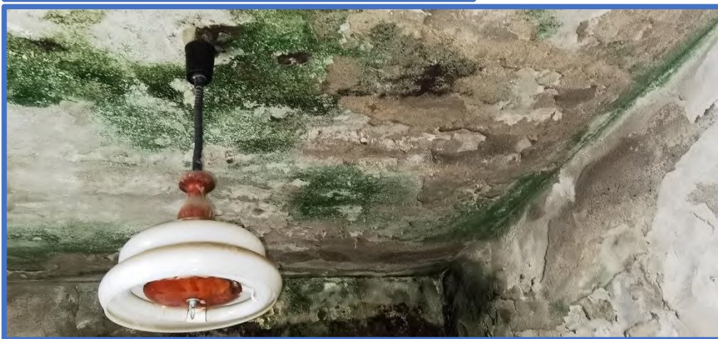
Foto 34 – Vista degrado solaio cucina.
