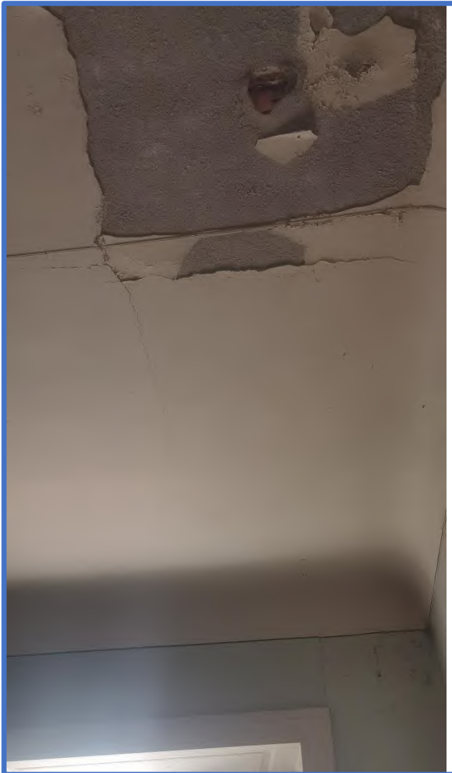
Foto 33 – Vista degrado controsoffitto.
