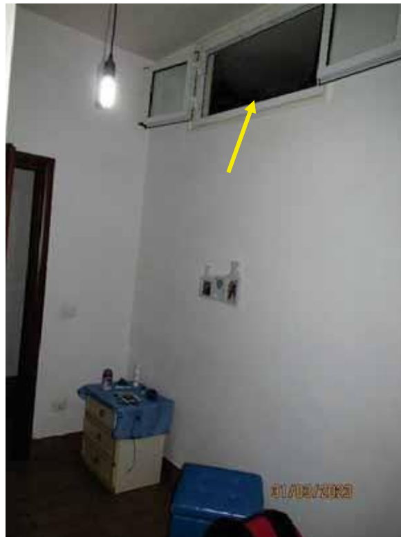
Fotografia 22 – Vano 2: Nella parte alta della parete divisoria con il “Vano 1”, a circa ml. 2,50 dal pavimento è installata una finestra avente altezza di circa ml. 0,50 apribile per consentire l'aerazione dell'ambiente poiché risulta privo di finestrate verso l'esterno.
