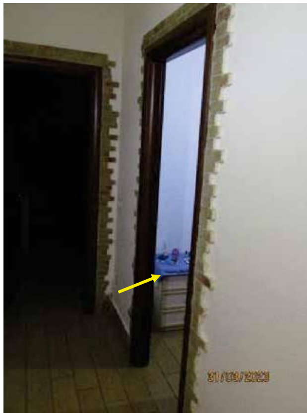
Fotografia 20 – Vano 2: Vi si accede dal “Corridoio”, occupa una superficie utile netta pari a mq. 8,46 ed un'altezza dal piano di calpestio di ml. 3,10.
