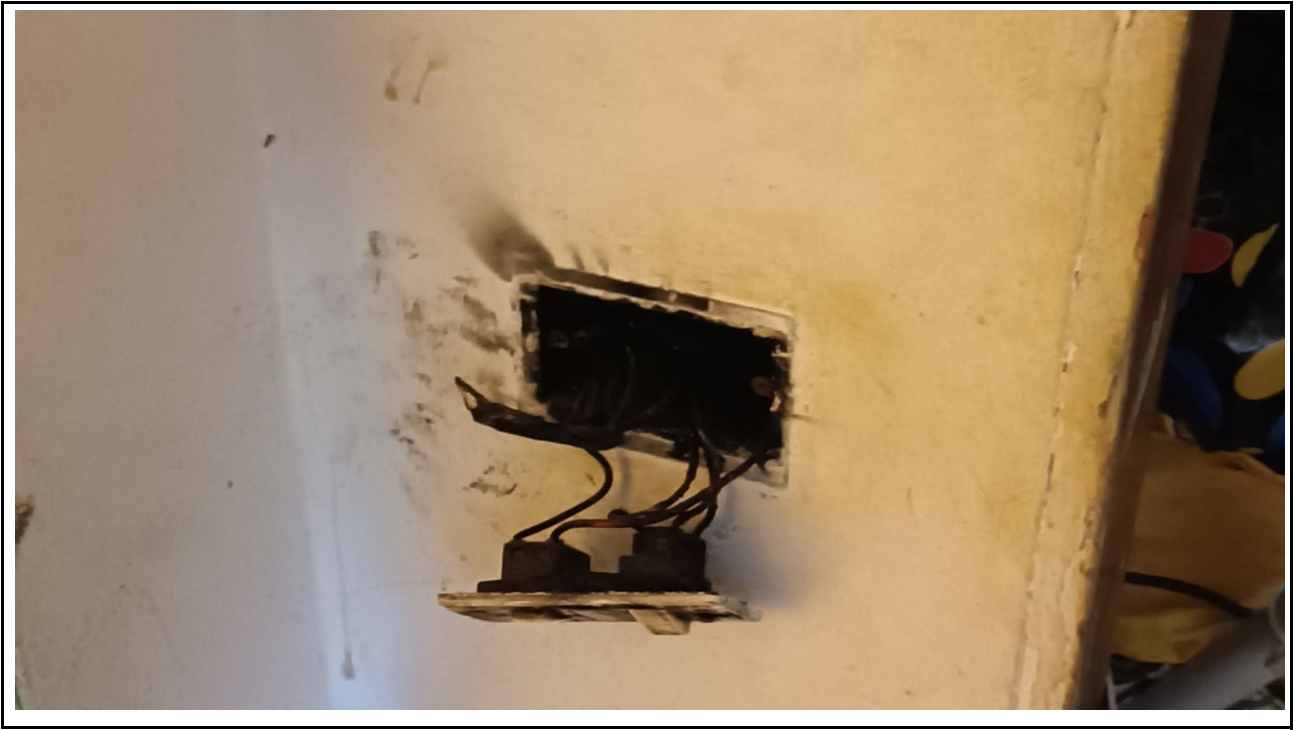
Foto n°33 - Impianto elettrico non a norma
