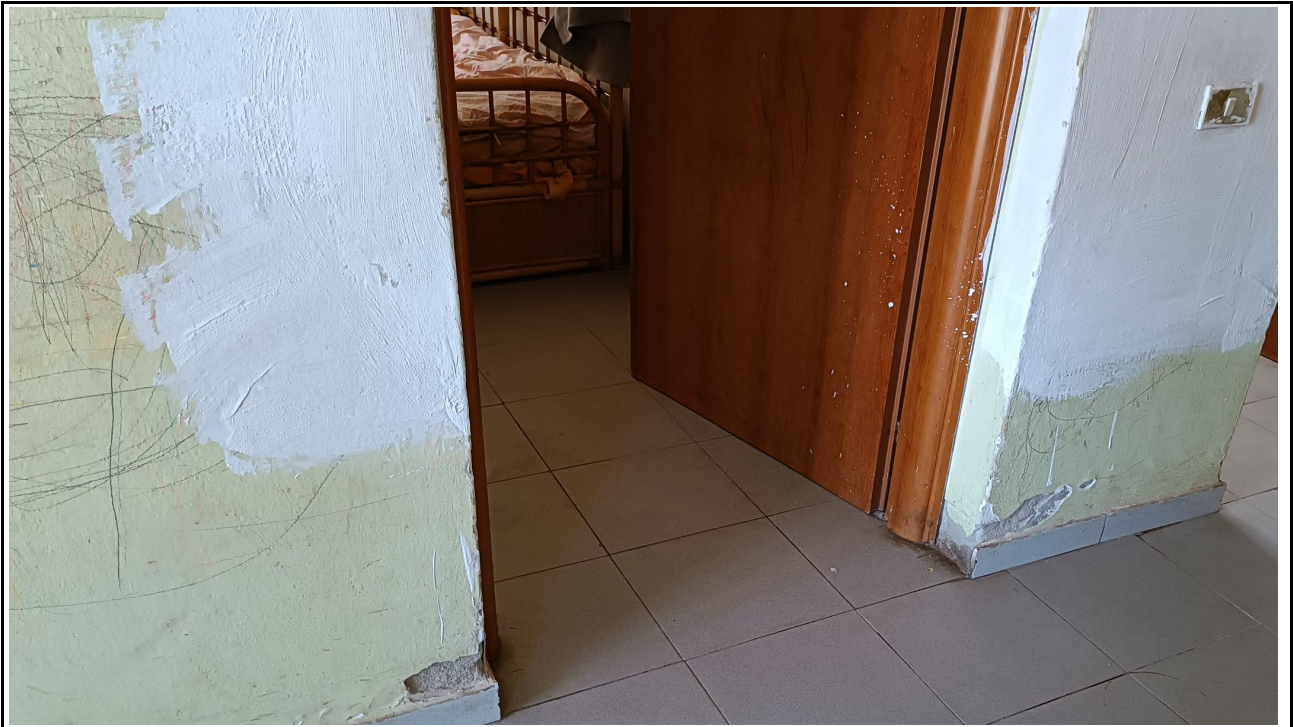
Foto n°24 - Soggiorno: infiltrazione dal basso parete
