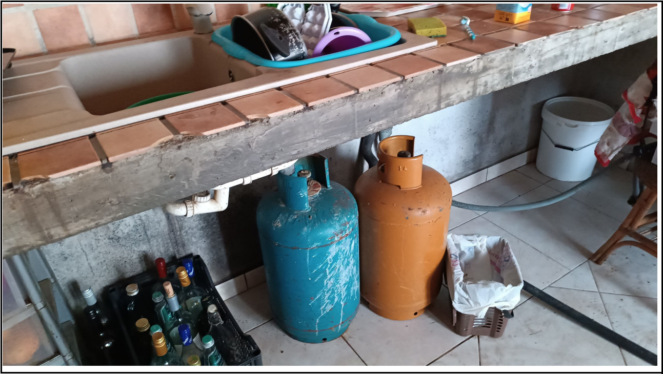
Foto n°31 - Cucina: tubazioni di scarico volanti
