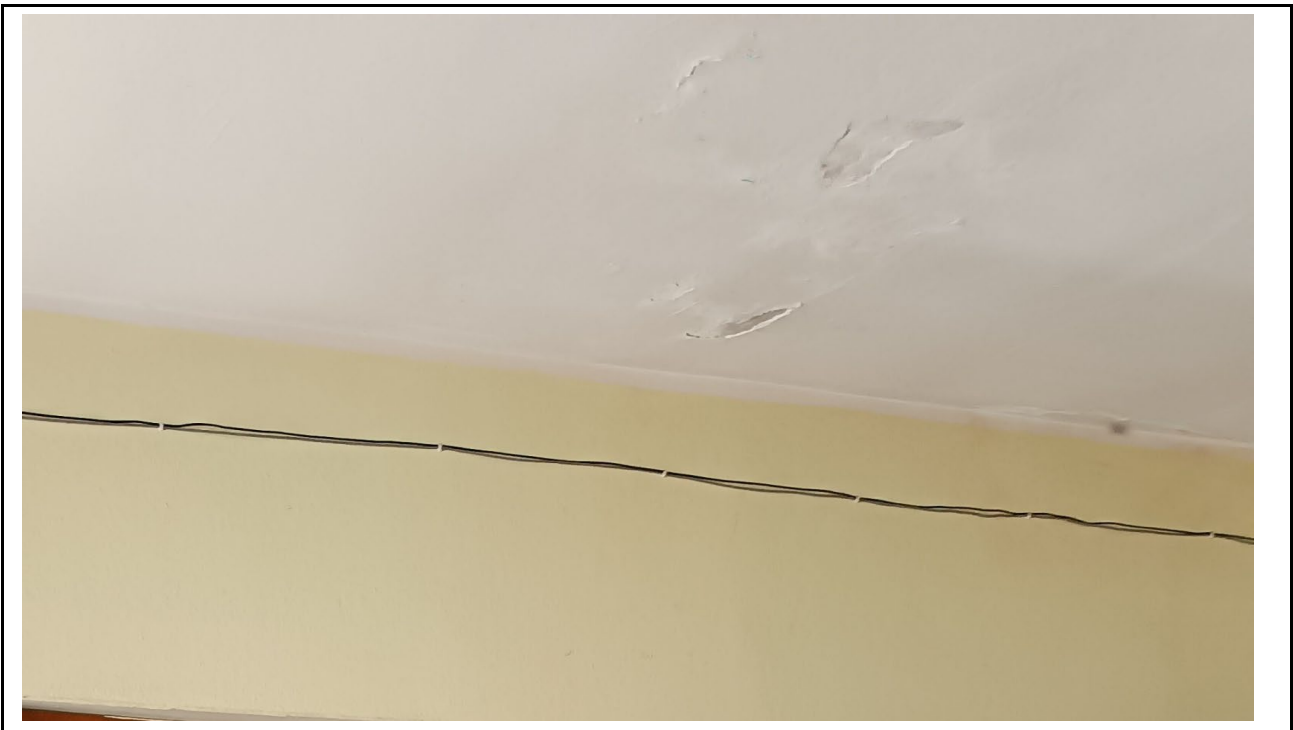
Foto n°22 - Soggiorno: infiltrazione soffitto
