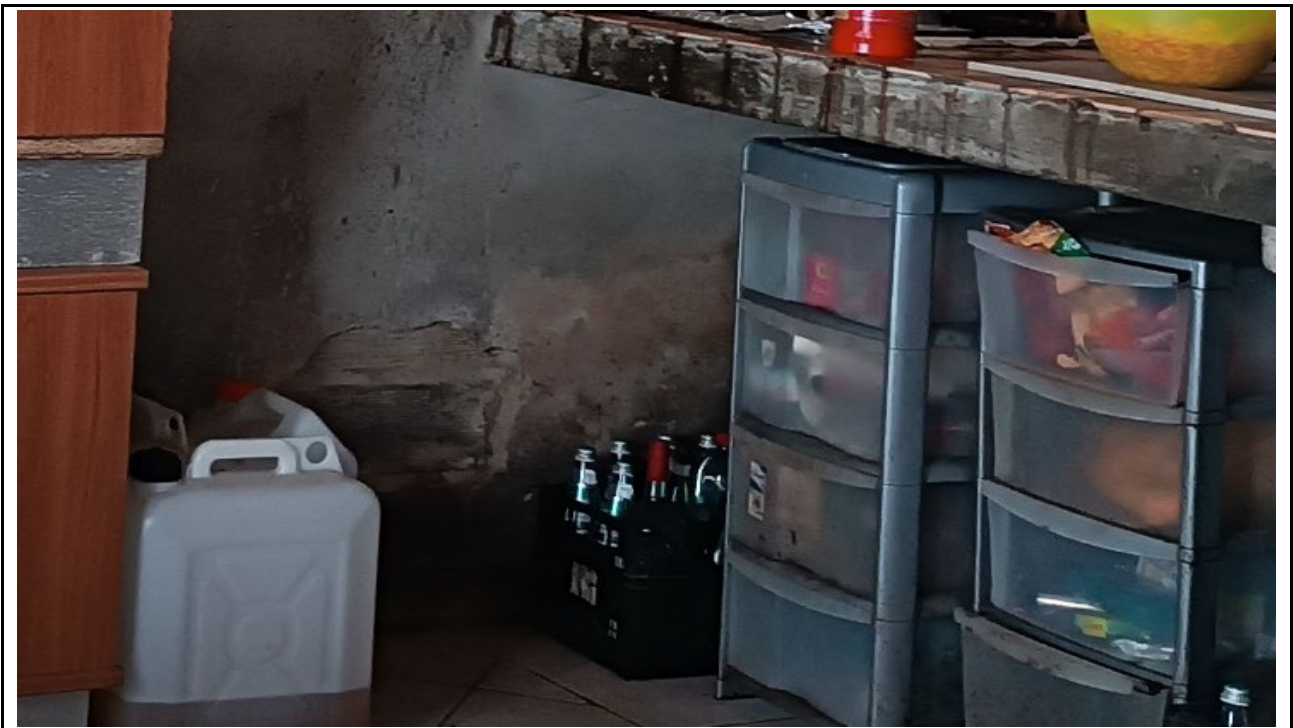
Foto n°28 - Cucina: infiltrazione dal basso parete
