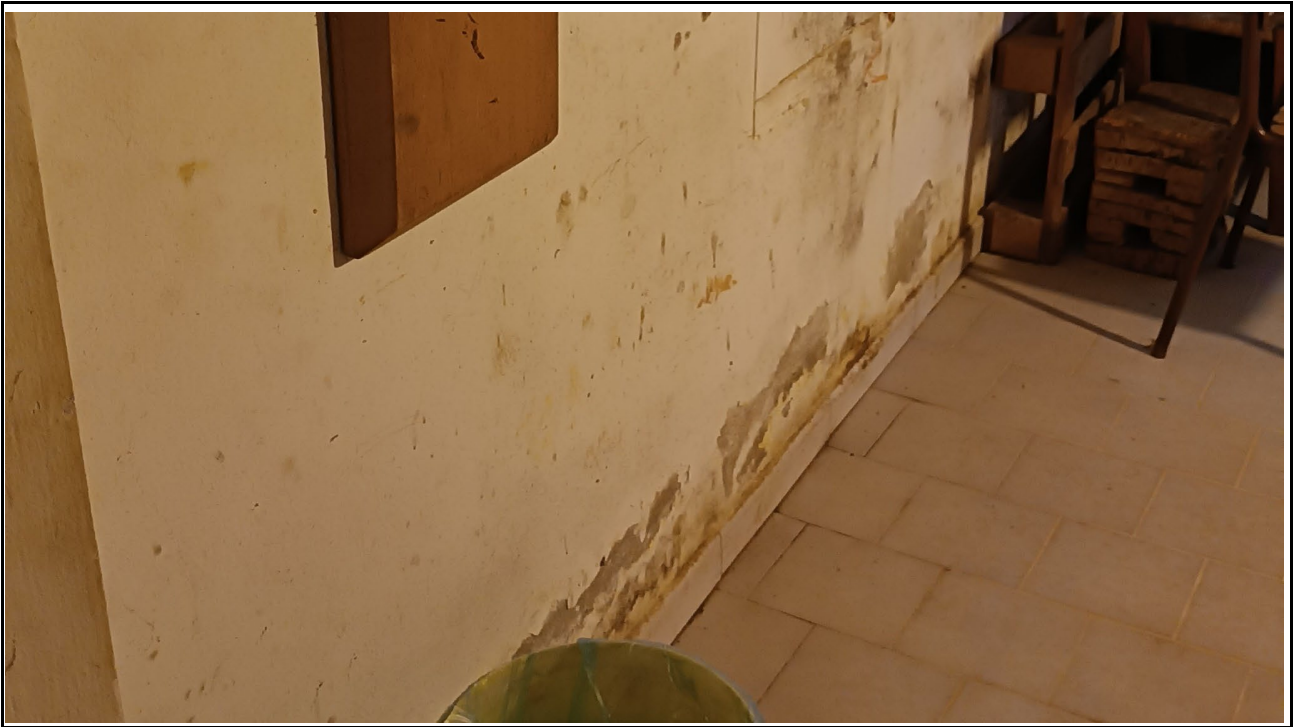
Foto n°27 - Pranzo: infiltrazione dal basso parete
