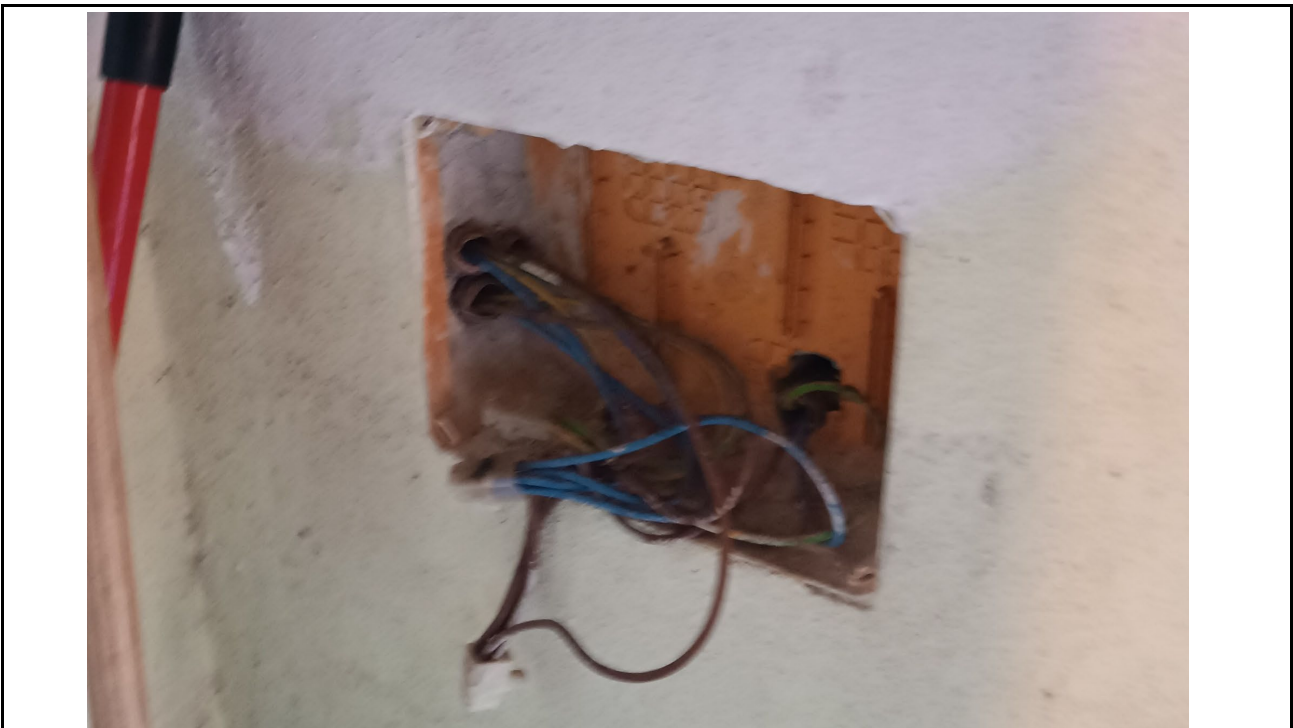
Foto n°34 - Impianto elettrico non a norma
