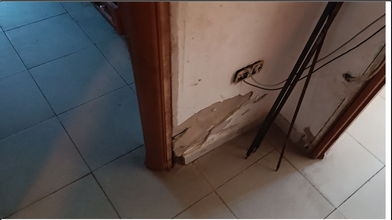
Foto n°26 - Andito: infiltrazione dal basso parete
