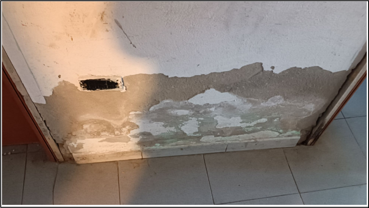
Foto n°25 - Andito: infiltrazione dal basso parete
