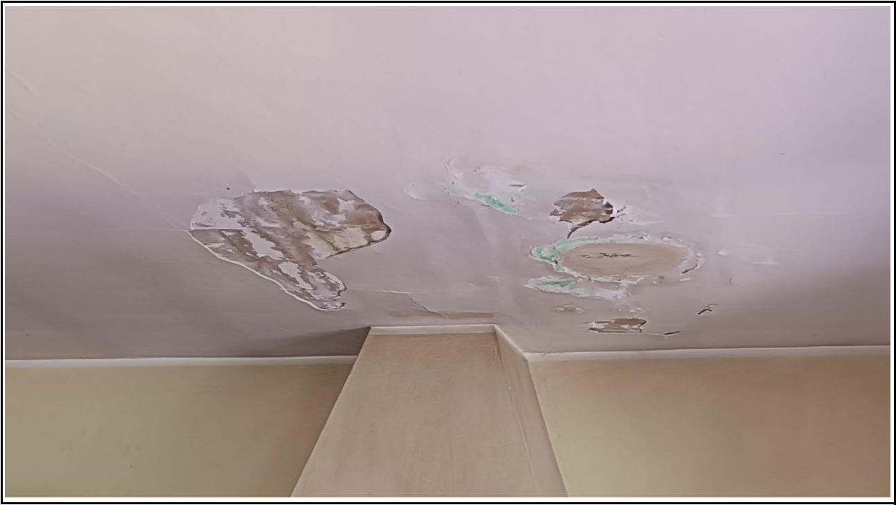
Foto n°21 - Soggiorno: infiltrazione soffitto
