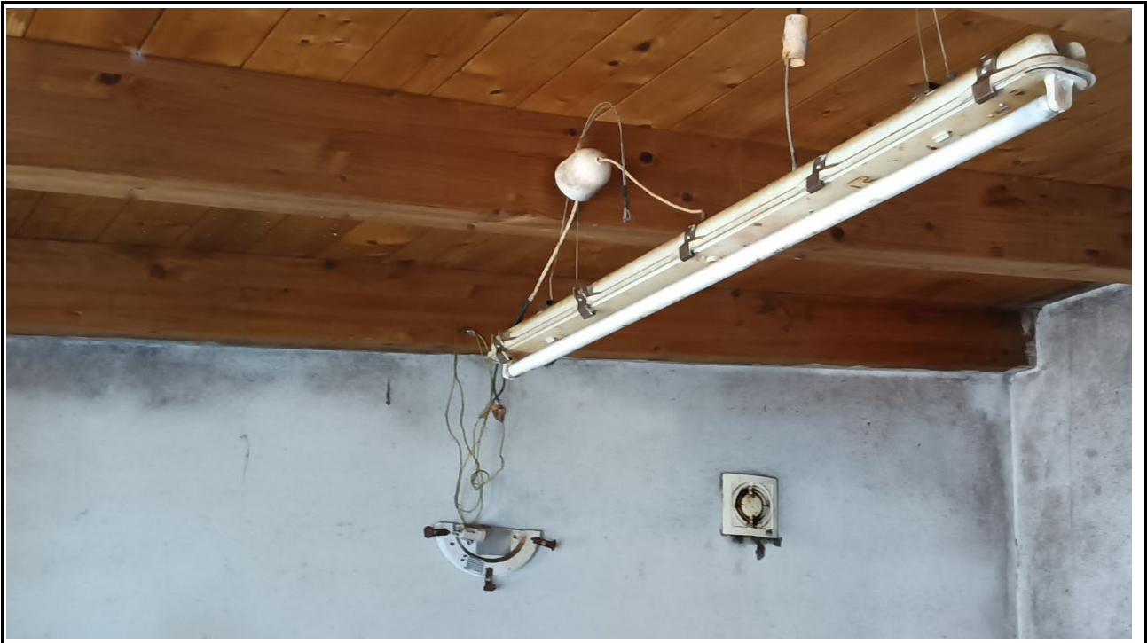
Foto n°36 - Impianto elettrico non a norma
