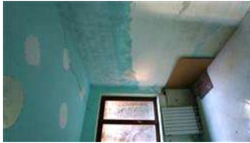
radiatore in ghisa non allacciato all'impianto di distribuzione dell'acqua calda
