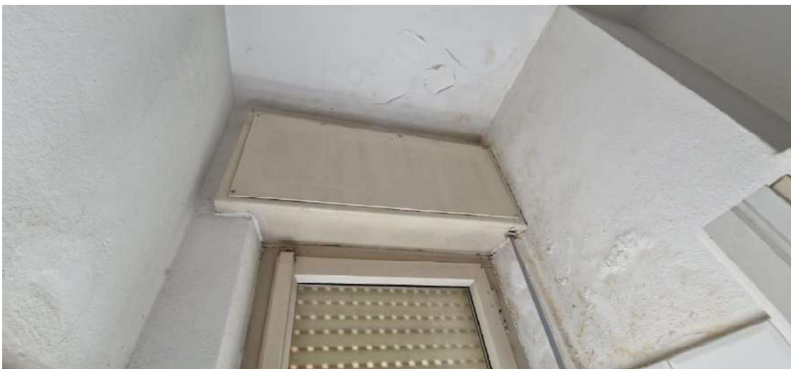
Viste dei danni dovuti ad infiltrazioni (bagno ad Est)
