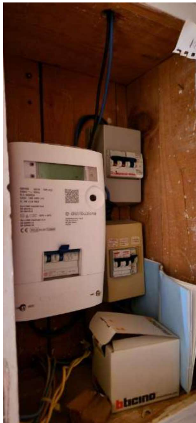
Vista del contatore e del quadro elettrico
