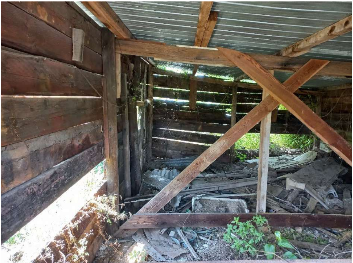
foto n.4 – interno della baracca fatiscente particella 1391
