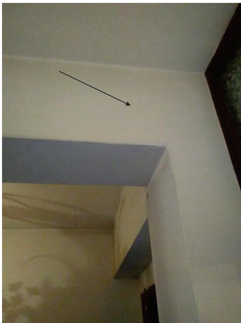
Lesione capillare sulla trave portante
