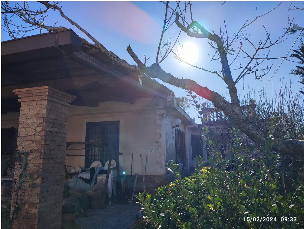
Foto 7 – Vista frontale/laterale che mostra le attuali condizioni della copertura del villino.
