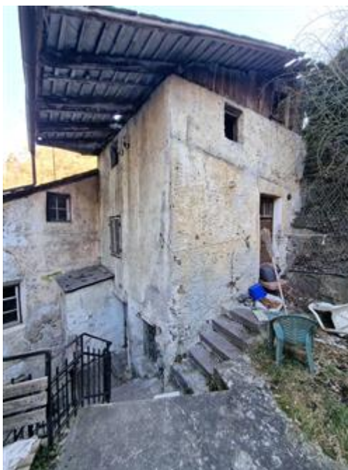
Corpo fatiscente locali deposito
