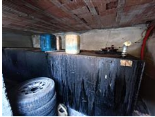
Locale con cisterna
