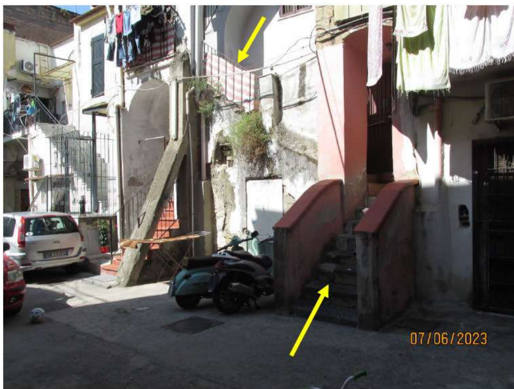
Fotografia 12 – La scala che conduce all'appartamento pignorato è la terza a sinistra per chi entra nella corte comune attraverso l'androne d'accesso. Risulta costituita in muratura portante addossata alla parete perimetrale, è all'aperto ed è dotata di ringhiera in ferro di protezione verso l'esterno. La scala conduce anche ad altri appartamenti posti al piano primo della palazzina.
