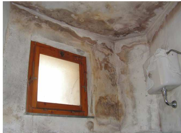
Foto 26 – Infiltrazioni bagno P.T.
