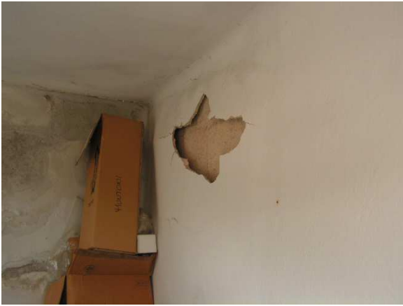
Foto 29 – Infiltrazioni vano accesso terrazza P.2
