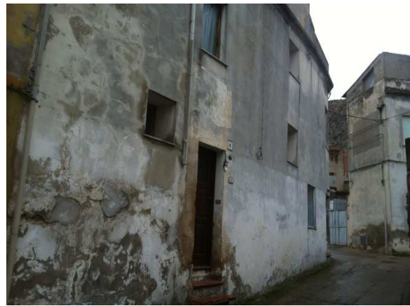
Foto 32 – Umidità da risalita capillare al P.T.
