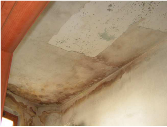
Foto 27 – Infiltrazioni bagno P.T.
