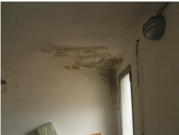
Foto 31 – Infiltrazioni vano accesso terrazza P.2
