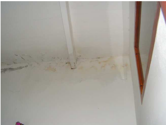
Foto 25 – Infiltrazioni bagno P.1
