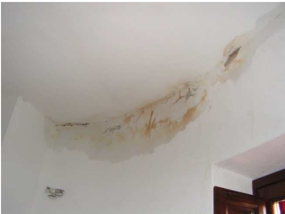
Foto 23 – Infiltrazioni camera matrimoniale P.1
