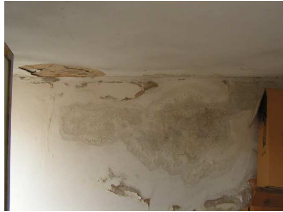
Foto 30 – Infiltrazioni vano accesso terrazza P.2
