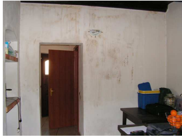
Foto 28 – Infiltrazioni cucina P.T.
