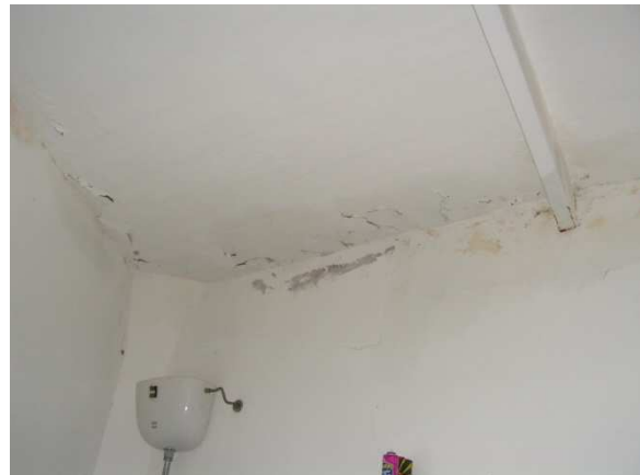
Foto 24 – Infiltrazioni bagno P.1
