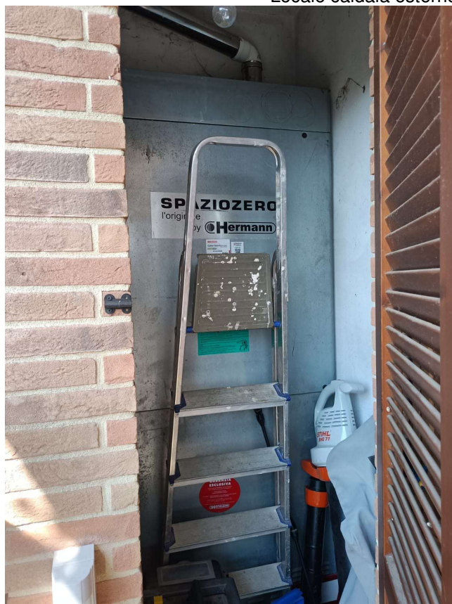
Locale caldaia esterno
