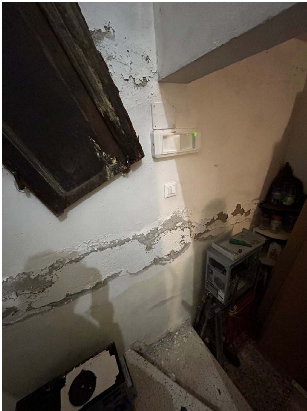
Affioramenti di umidità vano scala interno piano seminterrato - agg. 05 12 2024
