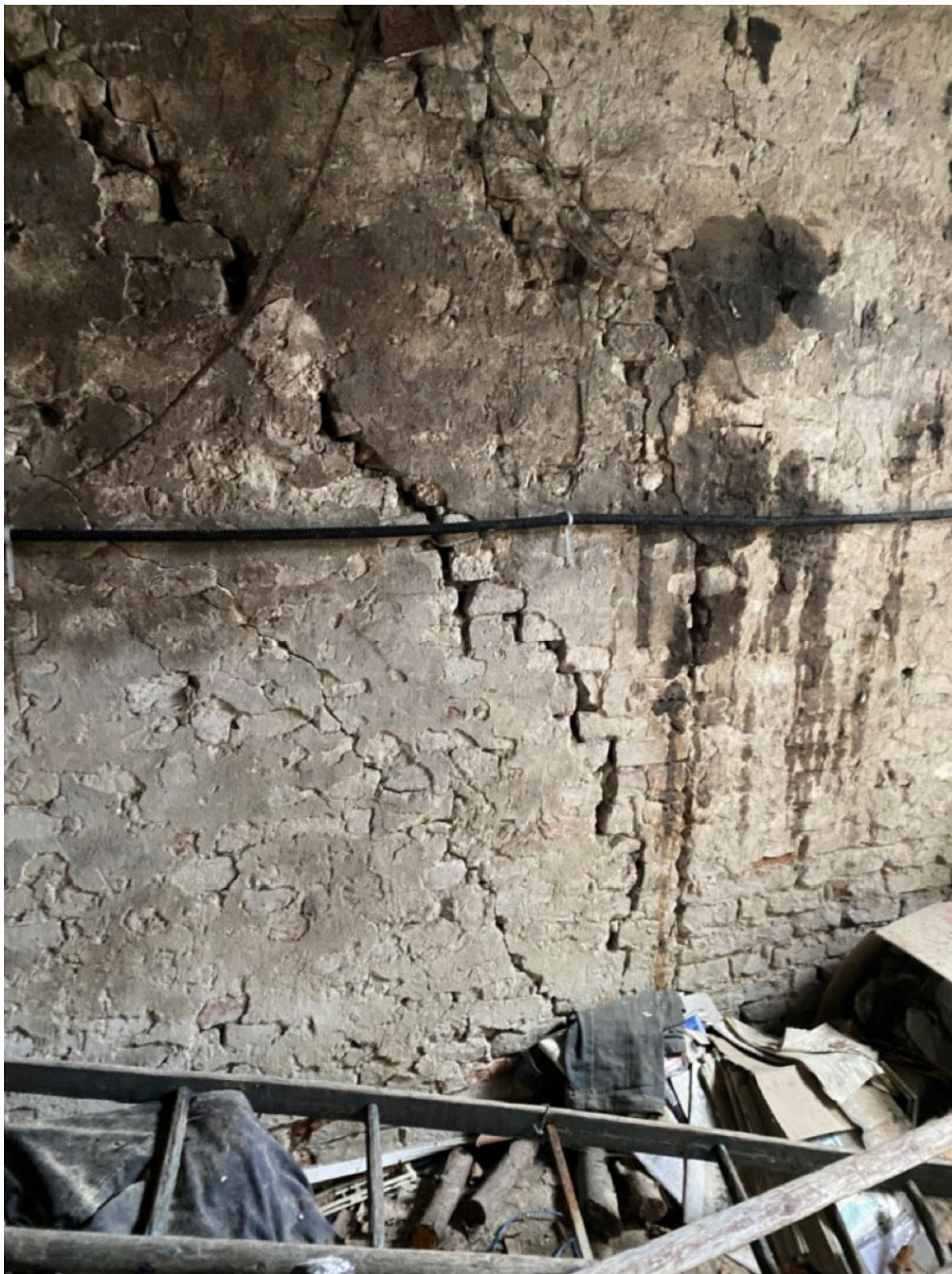
Fot. 18 - Foto del muro interno portante. In evidenza una preoccupante crepa strutturale a 45 gradi dovuta al cedimento strutturale del muro stesso dovuta da sovraccarico e da cedimento del terreno.
