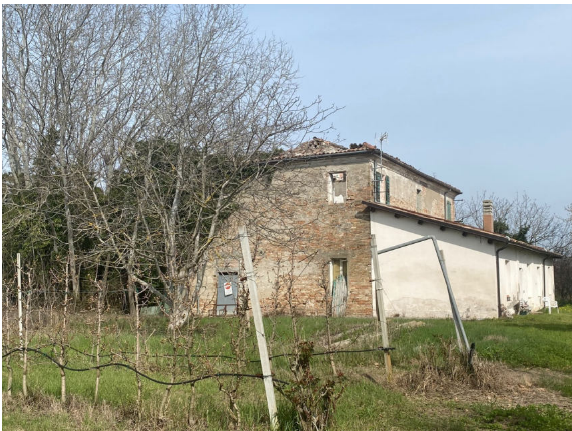
Fot. 14 - Foto laterale del fabbricato oggi. In evidenza il degrado strutturale dell'edificio.
