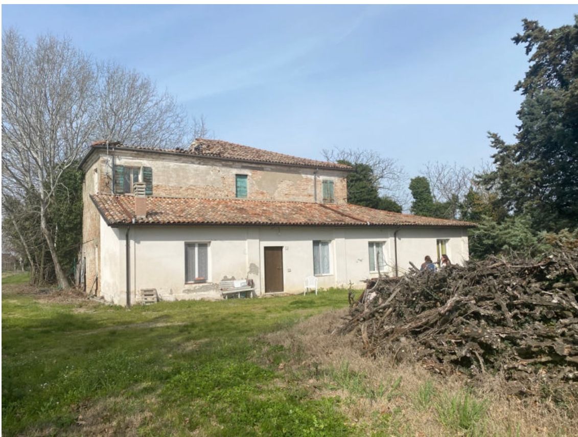
Fot. 13 - Foto del fabbricato oggi. In evidenza il crollo della copertura nella parte sinistra.
