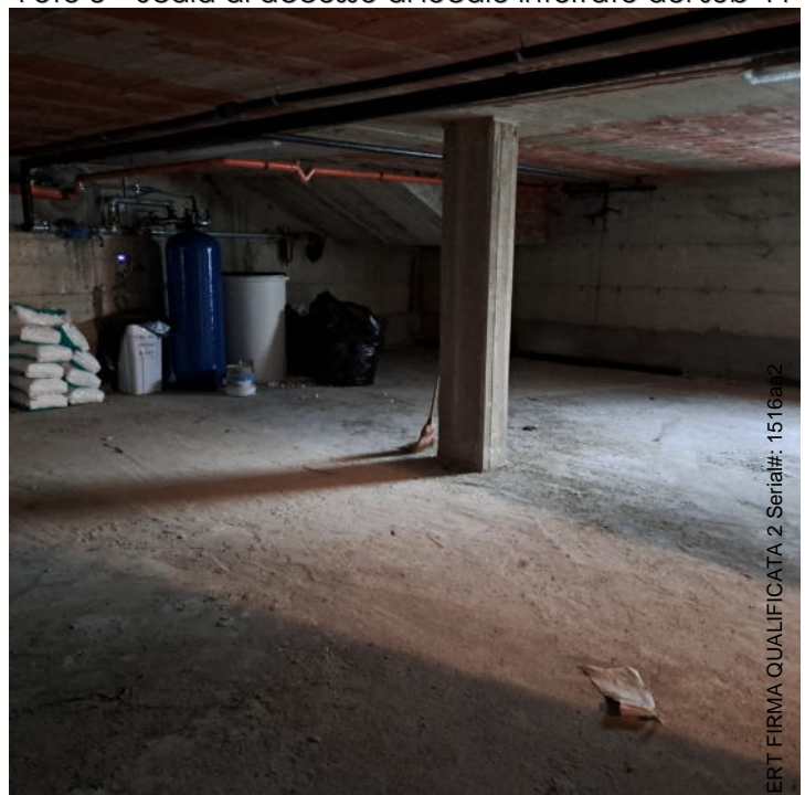
Foto 10 – Addolcitore acqua nel locale interrato al sub 44
