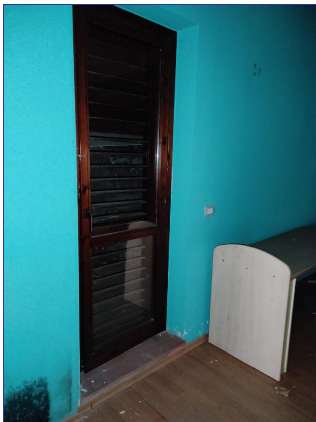
Foto 35 – Imm. 3 – Altra porta nella parte laterale che immette nell'intercapedine.
