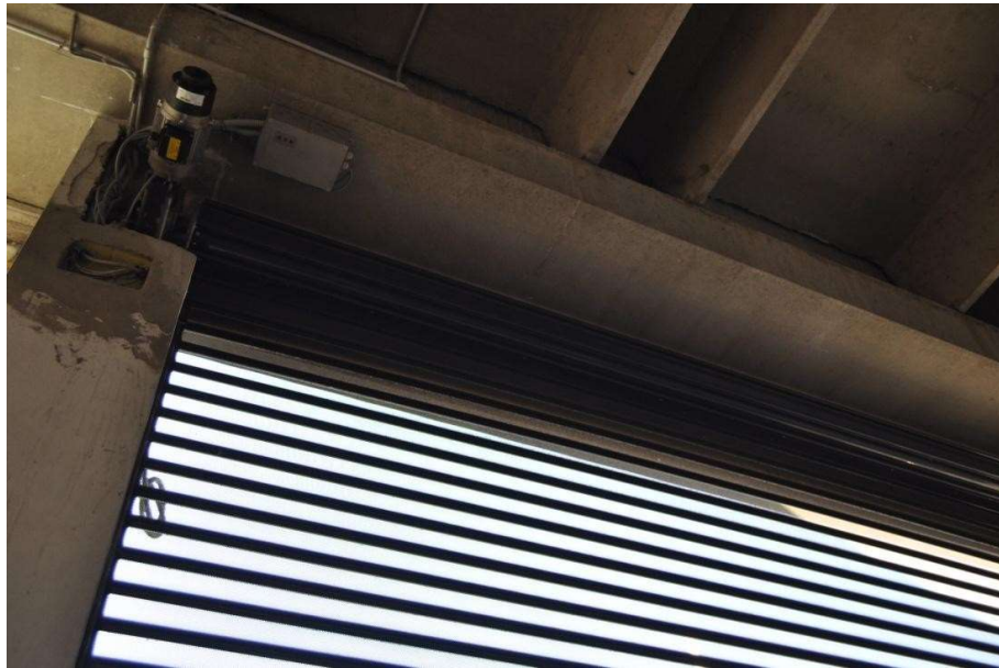
Serranda esterna servoassistita.
