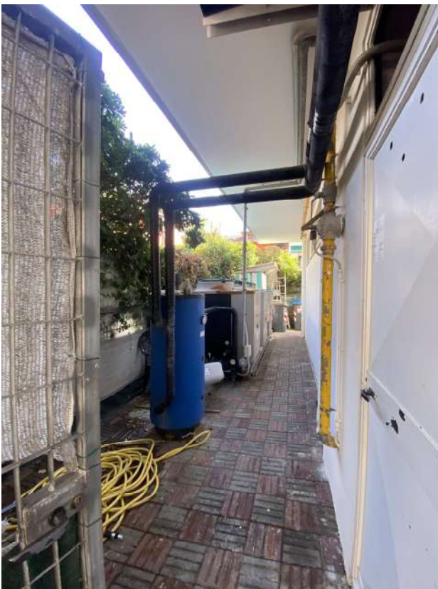
FOTO 8: Vista impianti esterni ubicato sul fronte Nord delimitati da recinzione metallica
