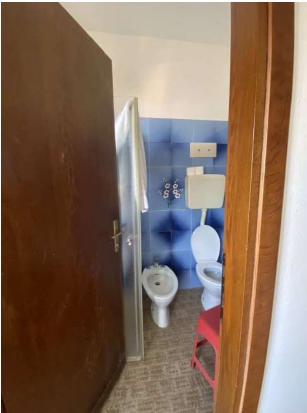
FOTO 22: Bagno "tipo" piano terzo
