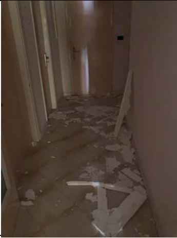
Disimpegno con distacco cornici: appartamento (sub19) piano rialzato.
