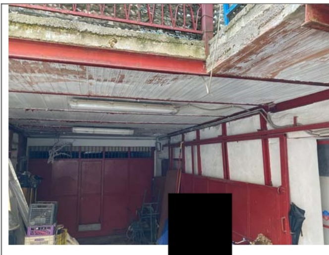
Garage: piano seminterrato p.lla 910 sub 38 e vista terrazzo abusivo.
