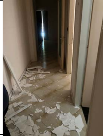
Disimpegno con distacco cornici: appartamento (sub19) piano rialzato.
