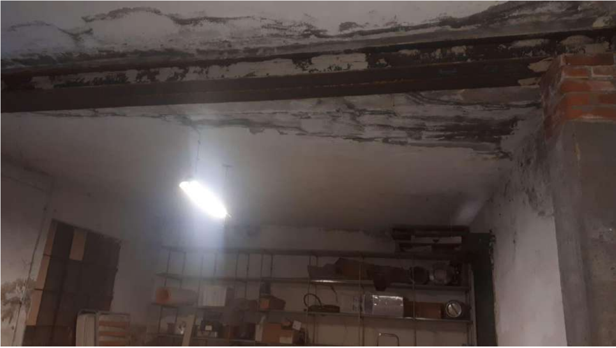
Dettaglio parti danneggiate presenti nel locale deposito
