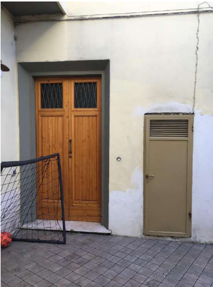
Ingresso principale e ingresso al locale tecnico dalla porta a fianco
