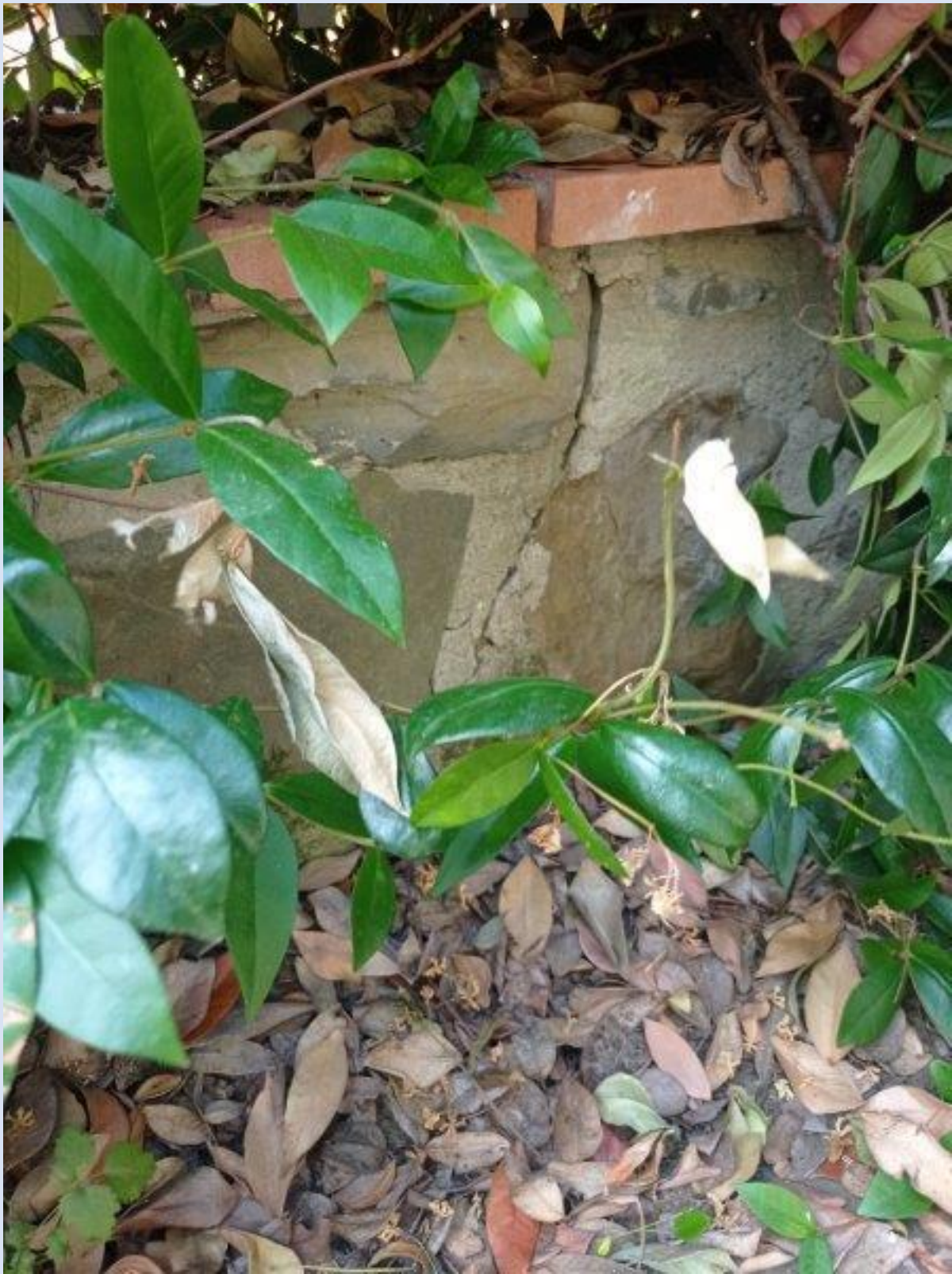
FIGURA 15 PARTICOLARE FESSURAZIONE SU MURETTO RESEDE TERGALE
