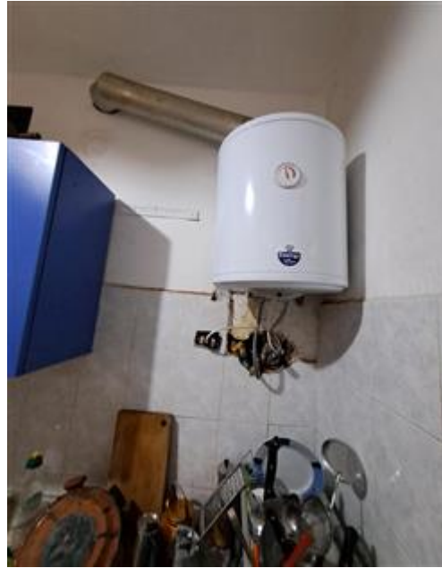
Boiler elettrico (vano ex ingresso)
