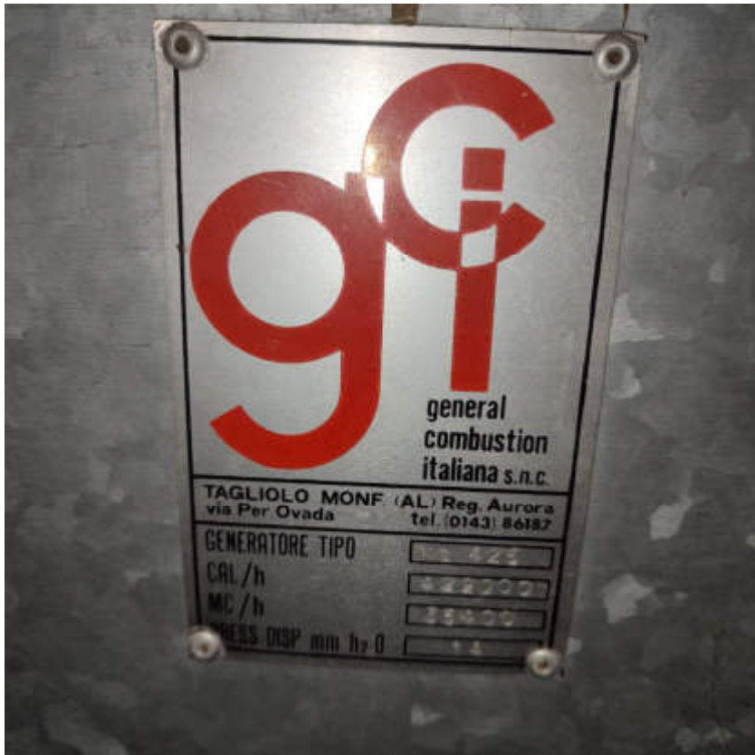
Vista esterna locale centrale termica e tipologia generatore principale
