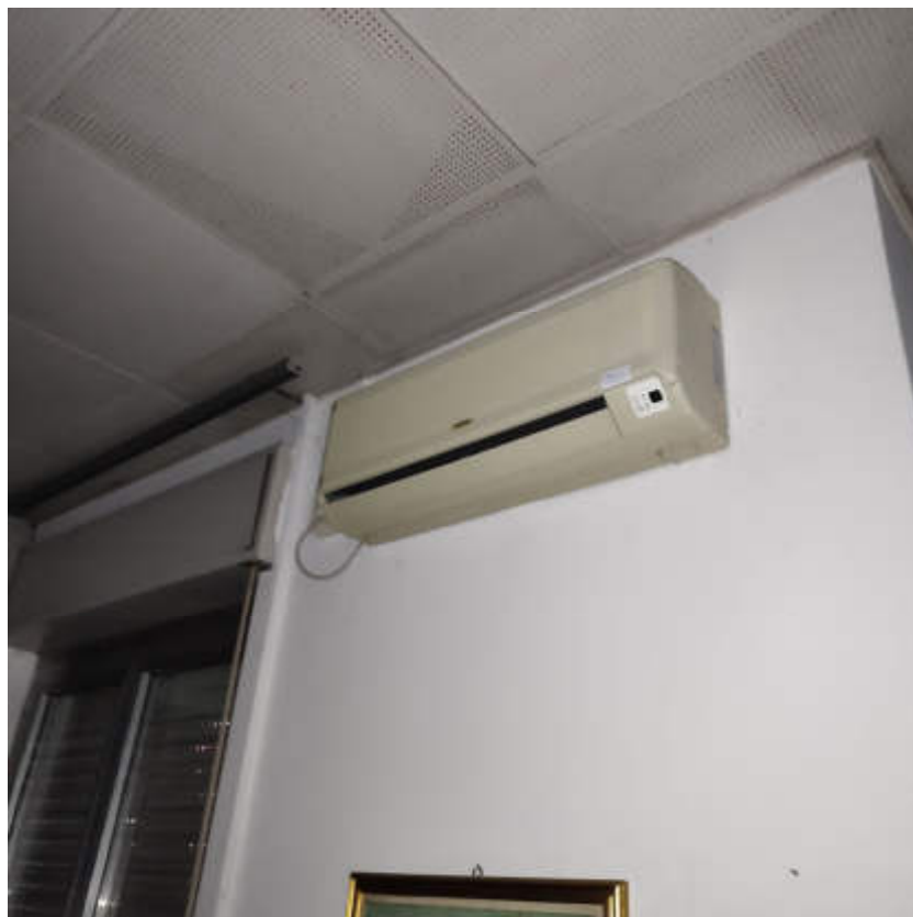
Tipologia split impianto climatizzazione a servizio dei locali direzionali in piano primo
