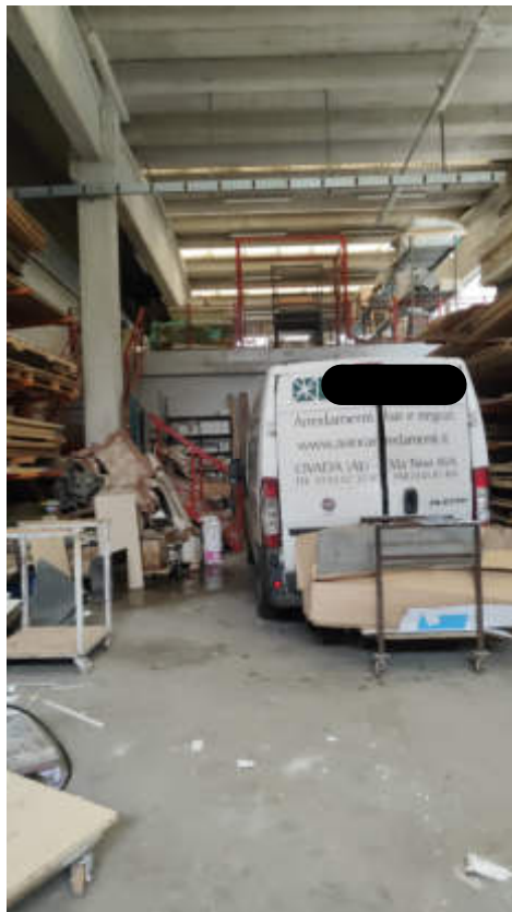
Vista interna al capannone dell'area interessata da fenomeni di stillicidio provenienti dalla copertura a tetto
