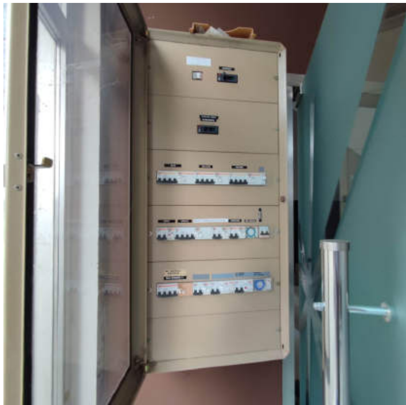
Vista quadri elettrici generali di comando
