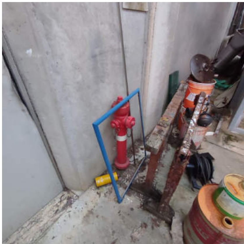
Vista sul fronte Est della posizione dell'idrante antincendio VVFF
