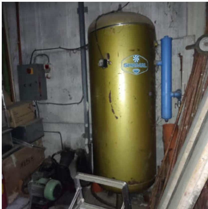
Vista interna dell'impianto di distribuzione aria compressa
