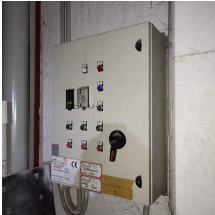
Vista interna quadro di comando cabina di verniciatura
