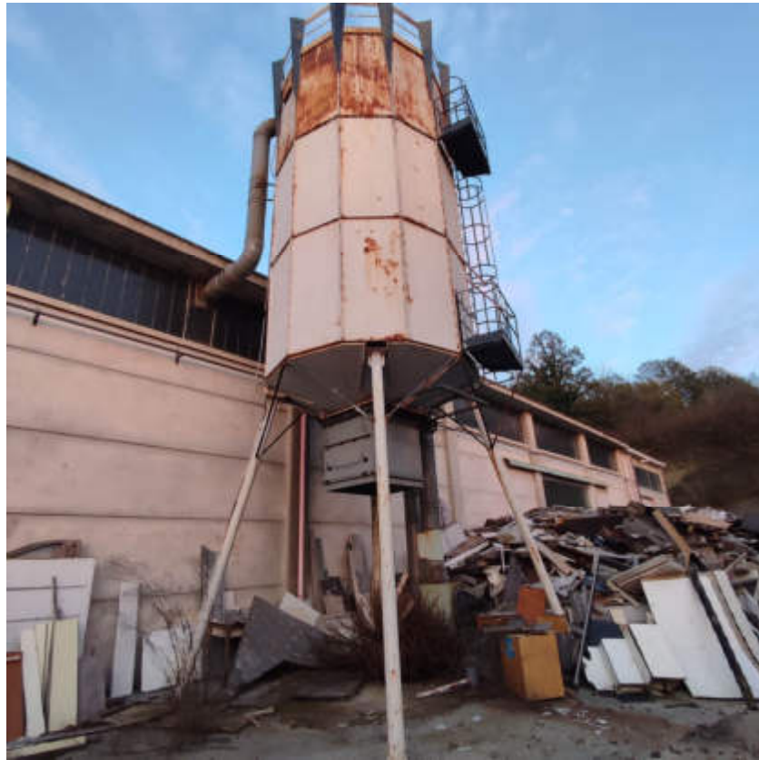
Vista esterna impianto aspirazione polveri
