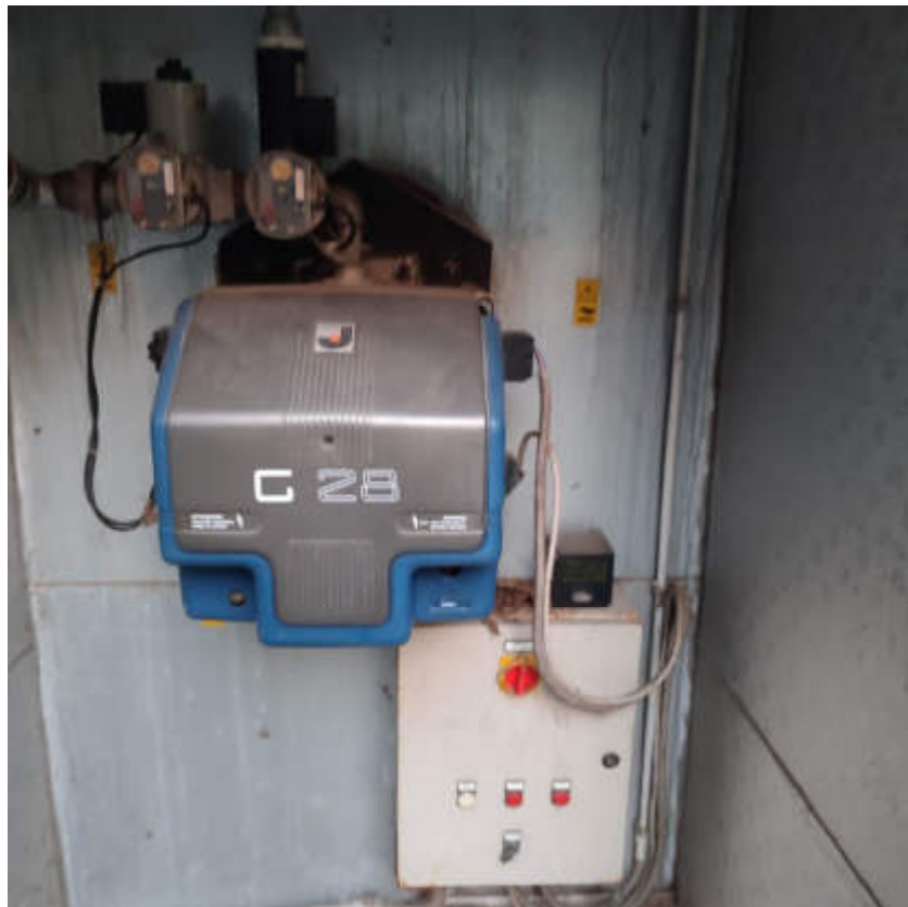
Vista esterna generatore di calore cabina verniciatura
