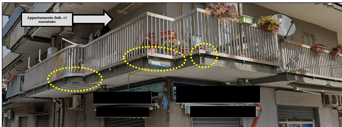
Foto 6: dettaglio degli esterni del Fabbricato condominiale “Palazzo De Francesco” , sito in Via G. B. Vignola civ. 44 di Eboli , in particolare dei SOTTO-BALCONI afferenti all’Appartamento esecutato (Sub. 17 al Piano Primo). Sono state rilevate lievi tracce di sfondellamento , con intonaco spicconato e parziale presenza di passivante delle armature.
