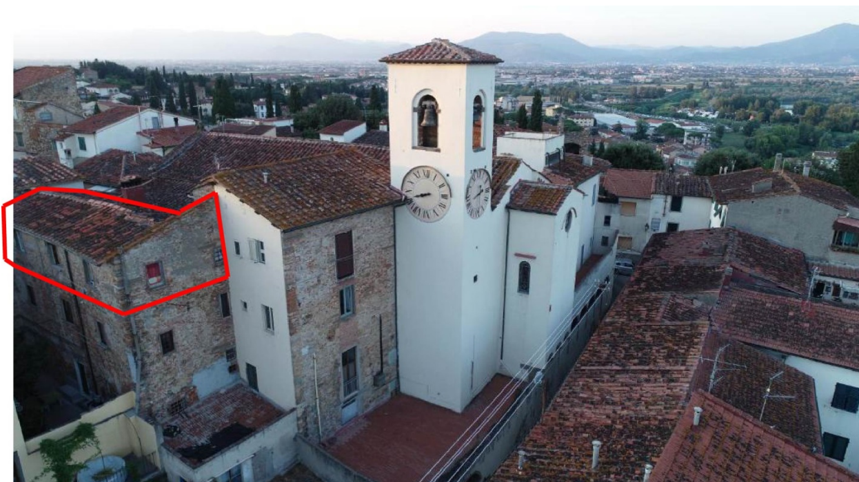
1. Individuazione del bene all'interno del contesto urbano: in primo piano il campanile dell'Orologio della Chiesa di S. Maria
