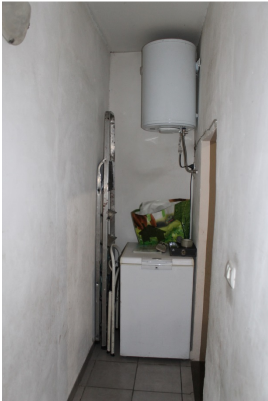
14. Corridoio con boiler elettrico
