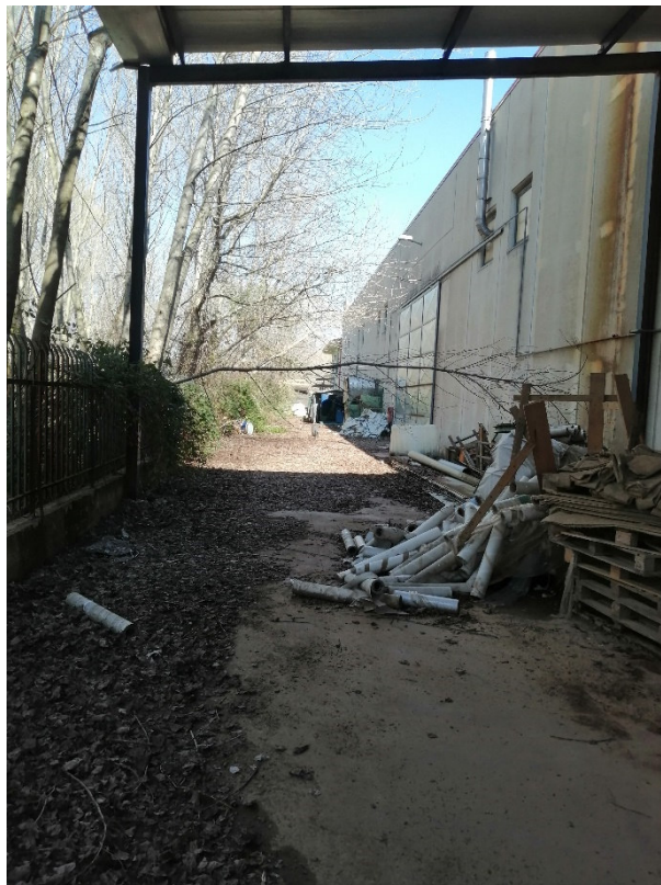
Foto n. 14 – Vista tettoia in ferro non autorizzata
