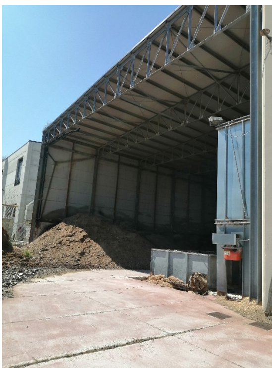
Foto n. 11 – Vista tettoia non autorizzata
