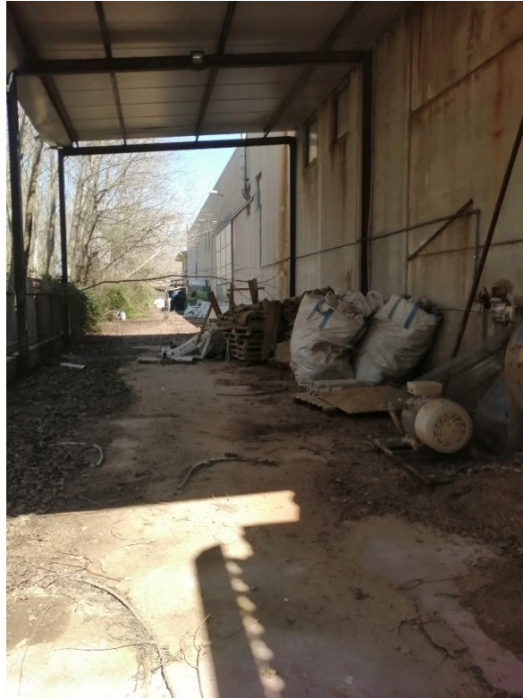
Foto n. 13 – Vista tettoia in ferro non autorizzata
