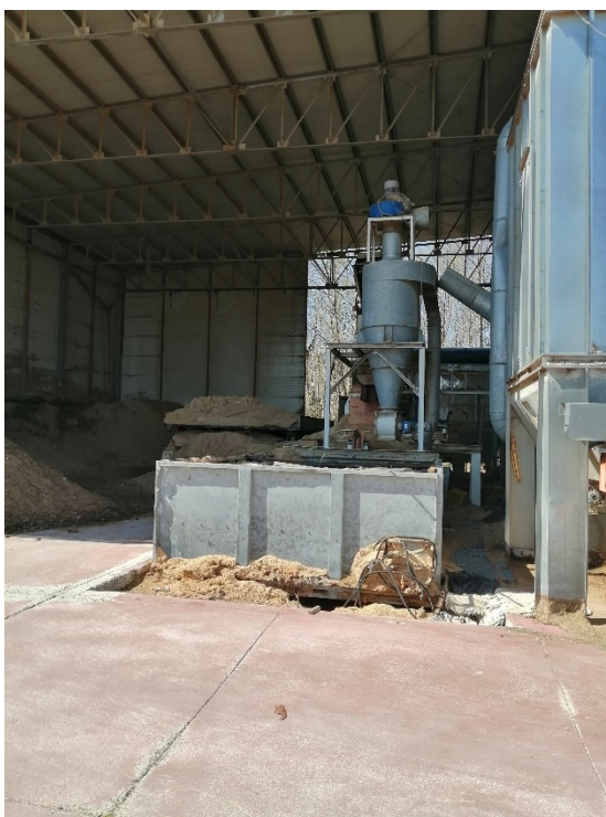
Foto n. 12 – Vista tettoia non autorizzata
