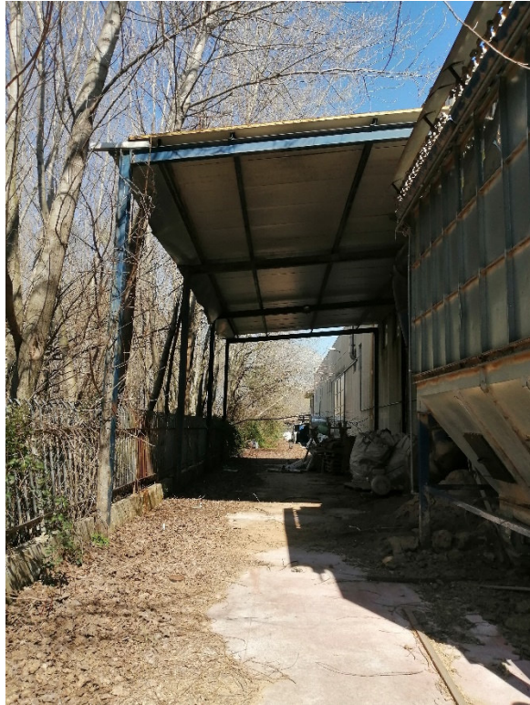
Foto n. 15 – Vista tettoia in ferro non autorizzata e macchinari
