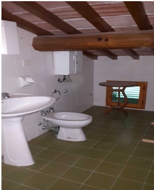
29 )Interno edificio A ( piano primo ) bagno soffitta
