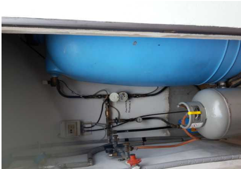
8) Interno del locale autoclave
