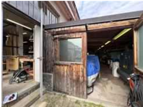
vista della porzione di fabbricato non autorizzato
