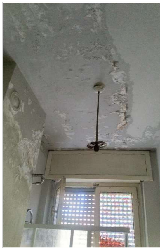
Le condizioni del plafone del bagno
