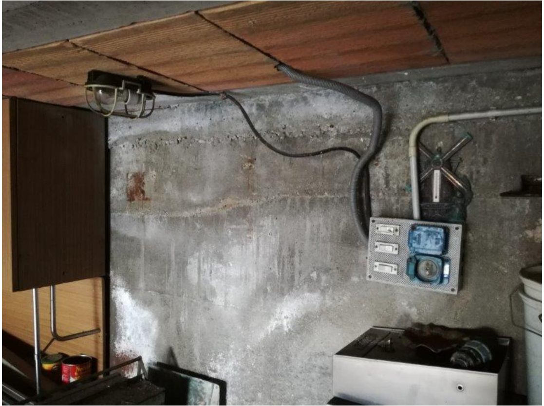
Foto 9: impianto elettrico esterno
