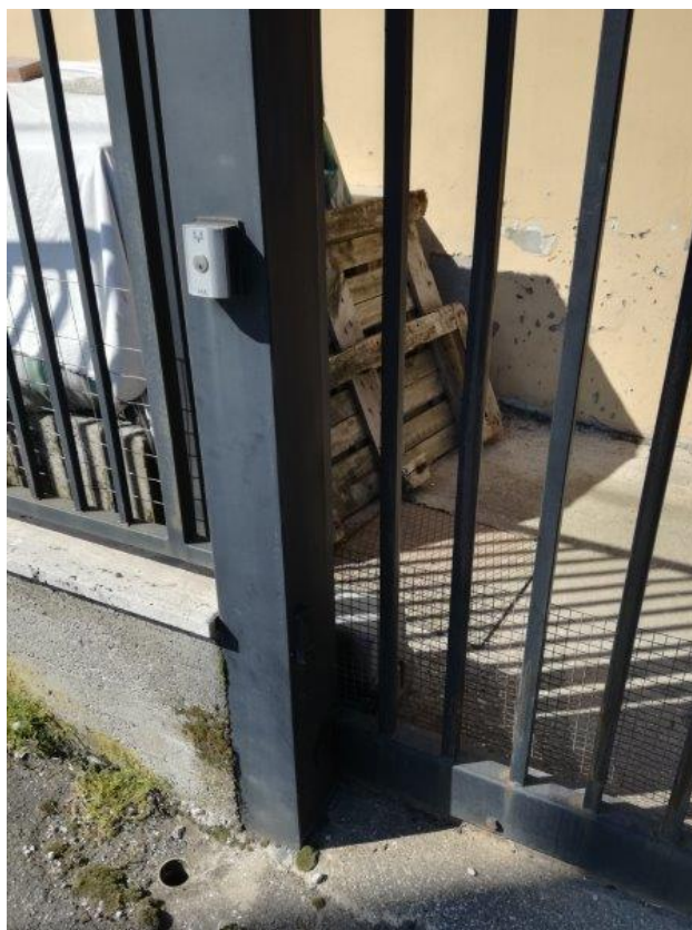
Foto 22: particolare chiave motorizzazione cancello
