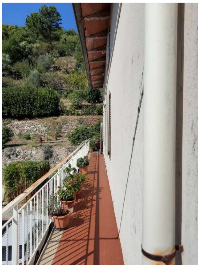
Foto n. 15 – balcone su resede a comune
