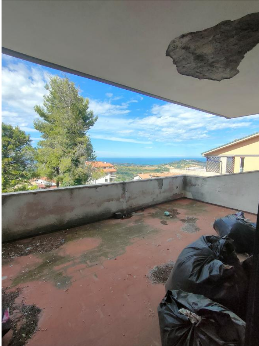
FOTO PARAPETTI TERRAZZO PIANO PRIMO – ASSENZA DI MANUTENZIONE (particolare scrostamento verniciatura e distacco intonaco dal cornicione)
