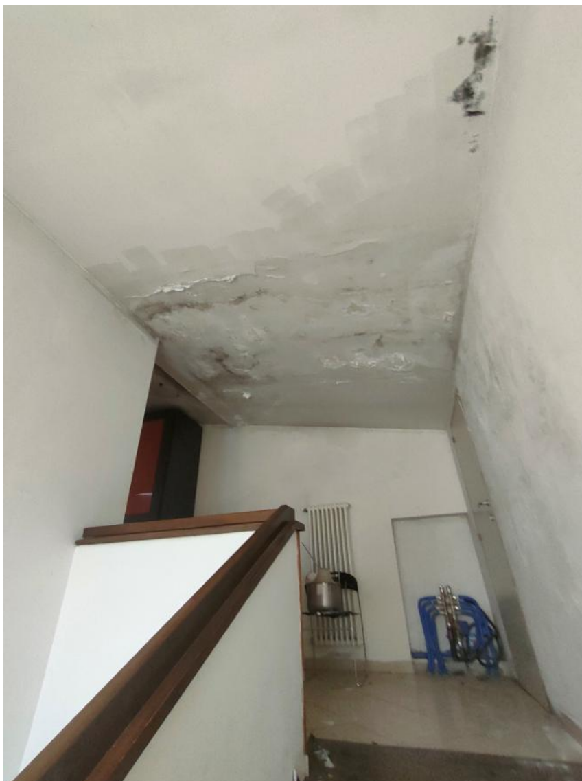
FOTO SOFFITTA PIANO SECONDO (PROBLEMI INFILTRAZIONI)
