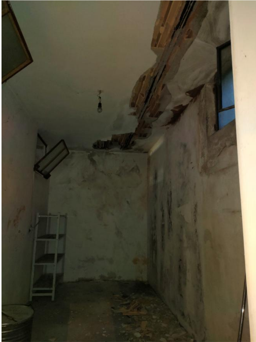
FOTO LOCALE INTERRATO – PROBLEMI INFILTRAZIONI (sfondellamento solaio)
