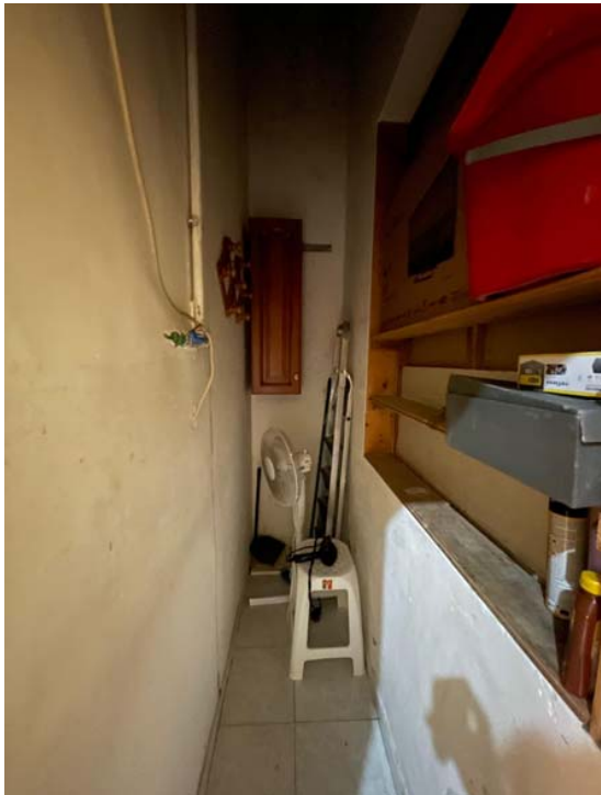
Piano terra - vista interna dell'abuso
