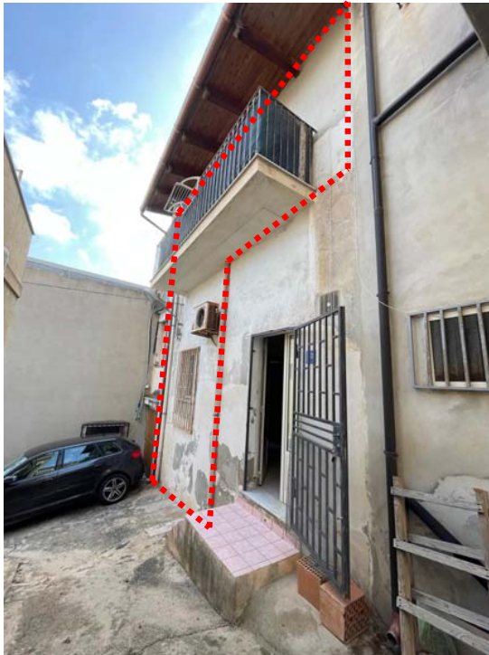
Vista interna fabbricato – individuazione degli abusi
