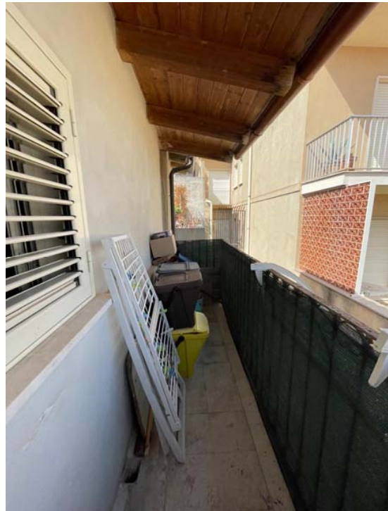
Primo piano - balcone abusivo
