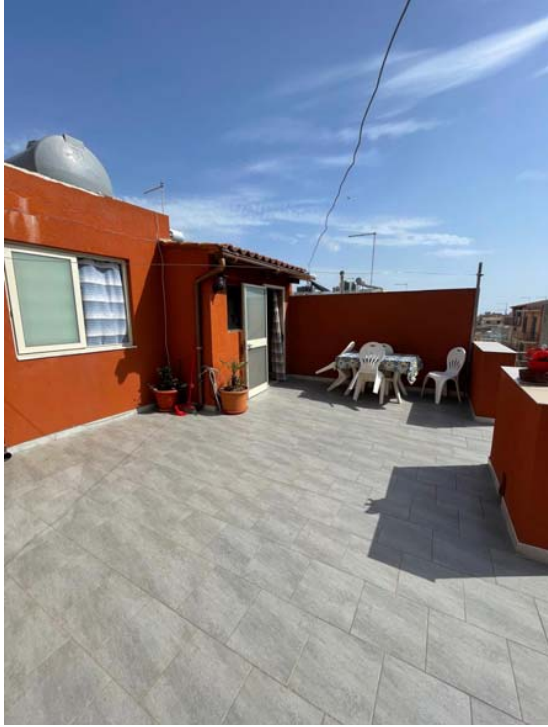
Primo piano – vista esterna dell'abuso
