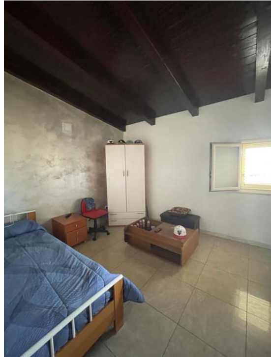
Piano primo - vista interna dell'abuso
