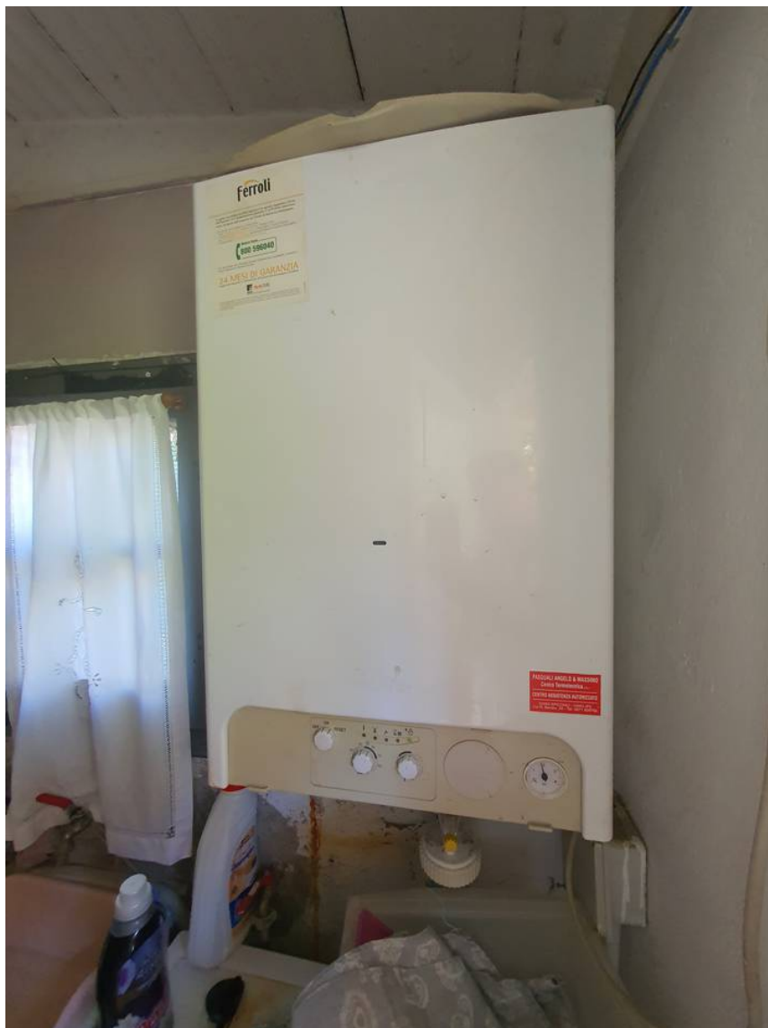
Foto37 – Caldaia nel deposito esterno.
