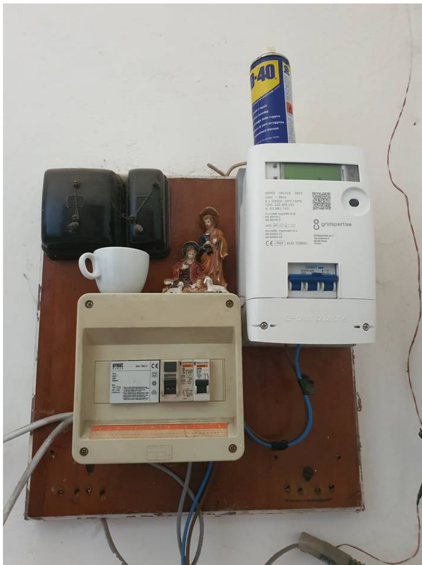
Foto 33 – Contatore elettrico all'interno del disimpegno a comune.
