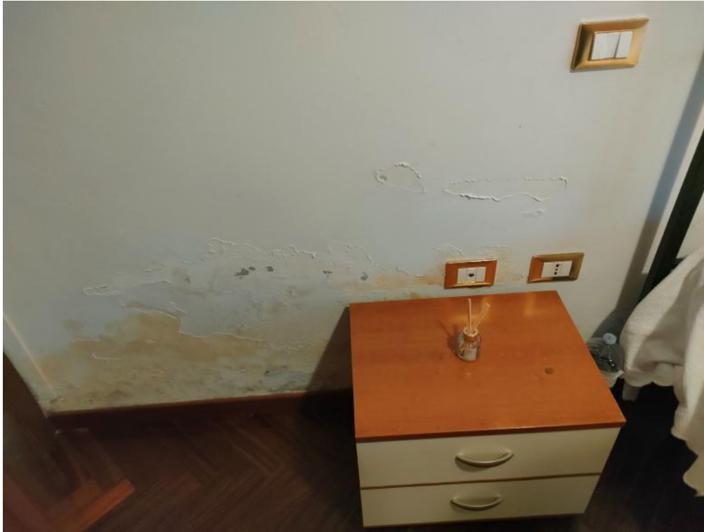
INFILTRAZIONI DAL BAGNO PARETE CAMERA
