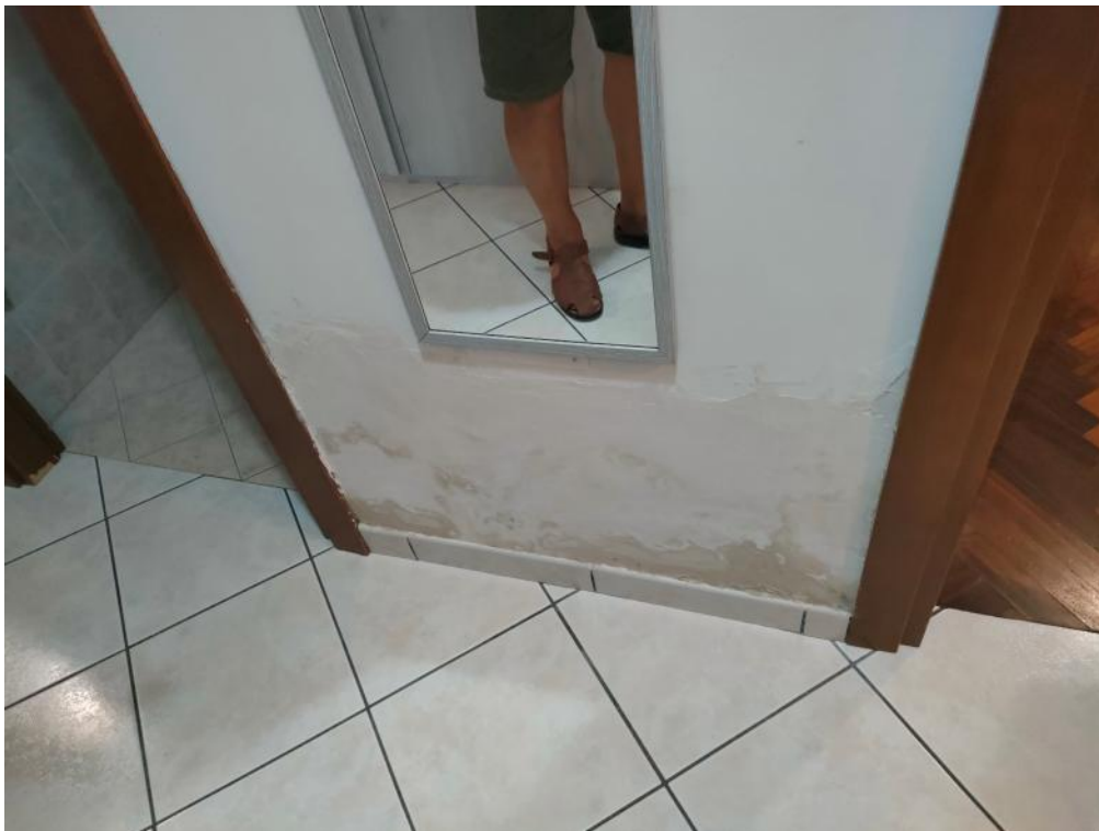
INFILTRAZIONI DAL BAGNO PARETE DISIMPEGNO
